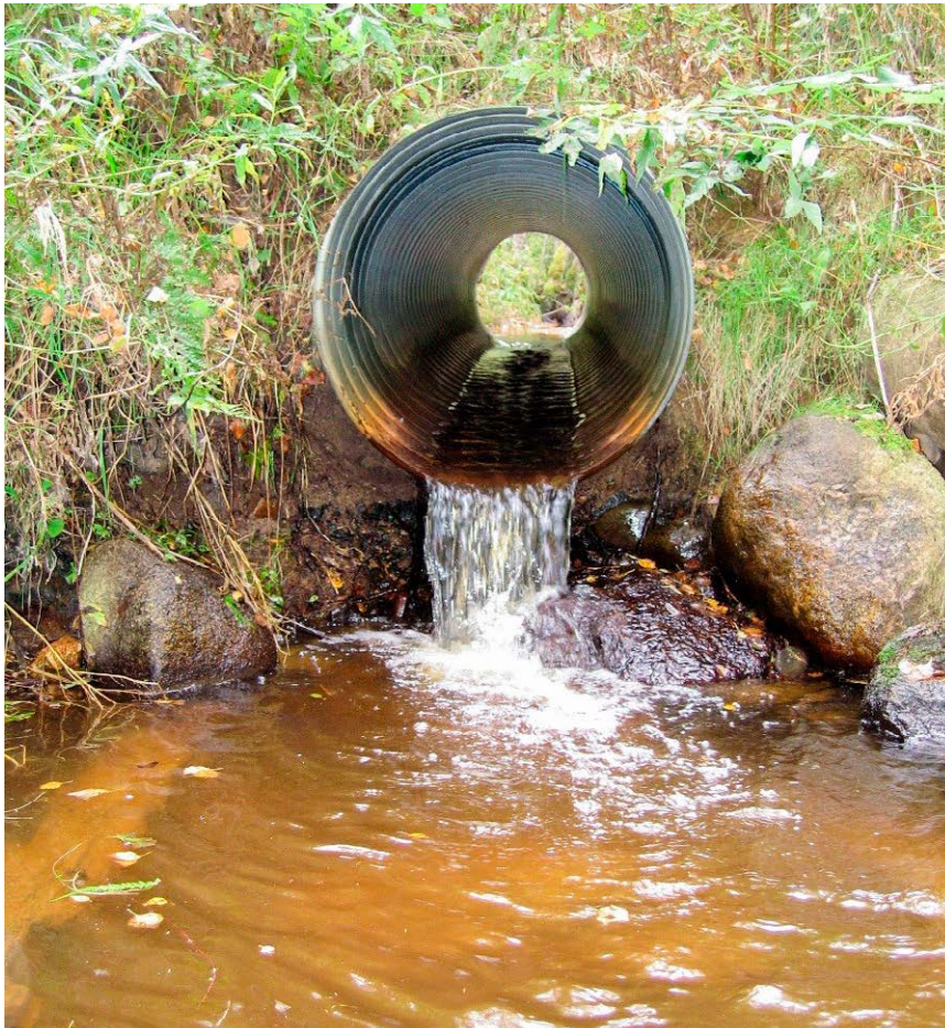
Kuva 6. Liian korkealle asennettu rumpu
