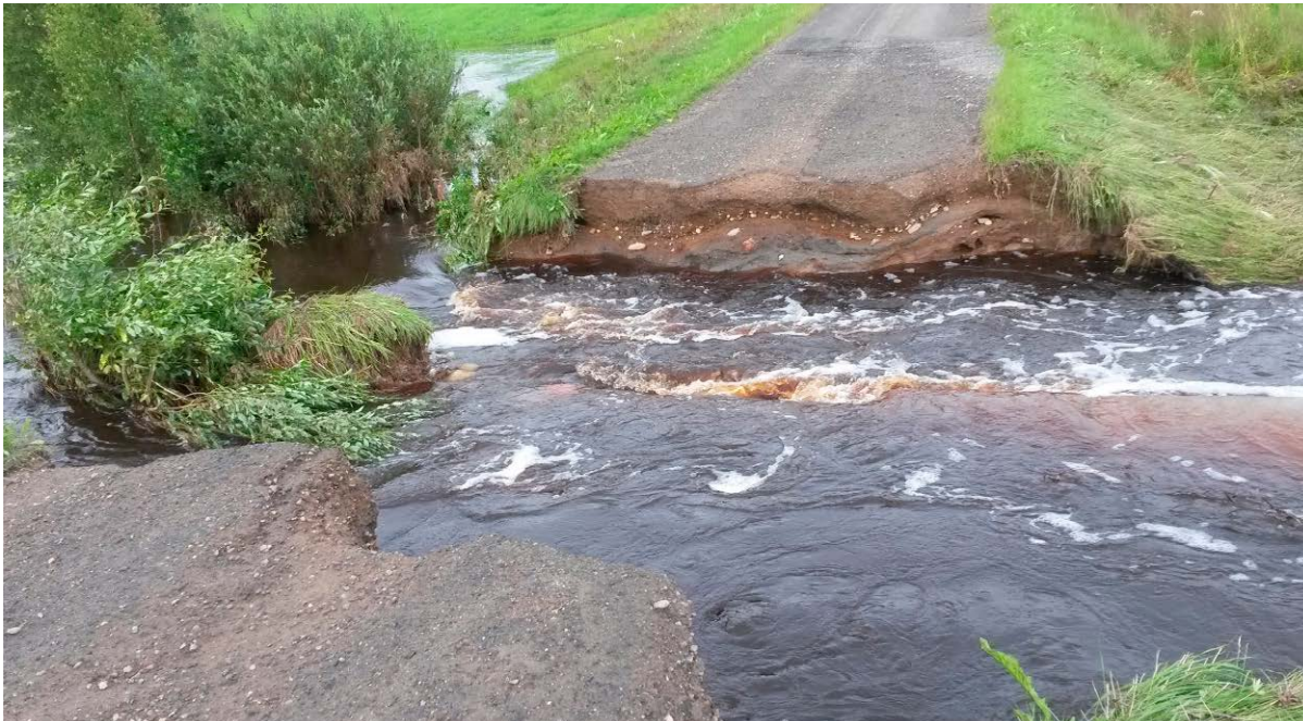
Kuva 8. Rankkasateen aiheuttaman tulvimisen seurauksena sortunut tie
