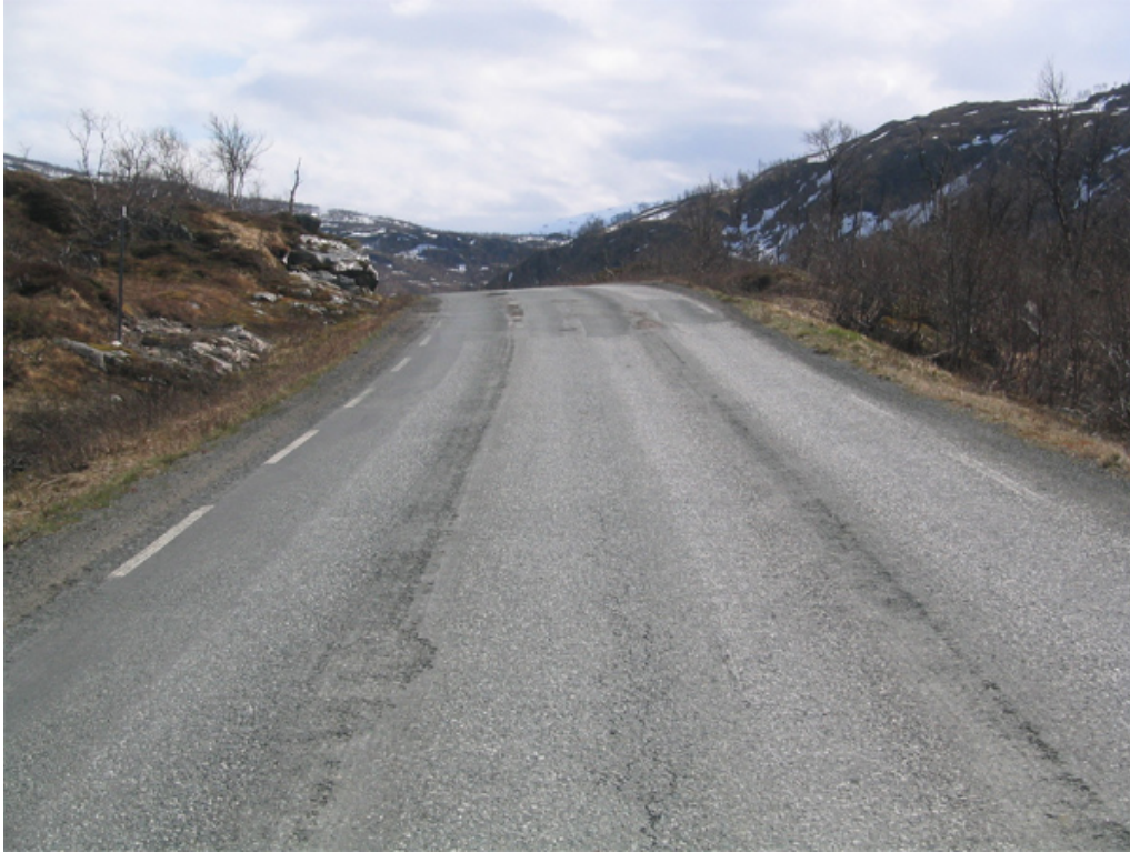
Kuva 30 Sitomattomien kerrosten deformaatiosta aiheutuvaa urautumista (Roadex e-Learning)
