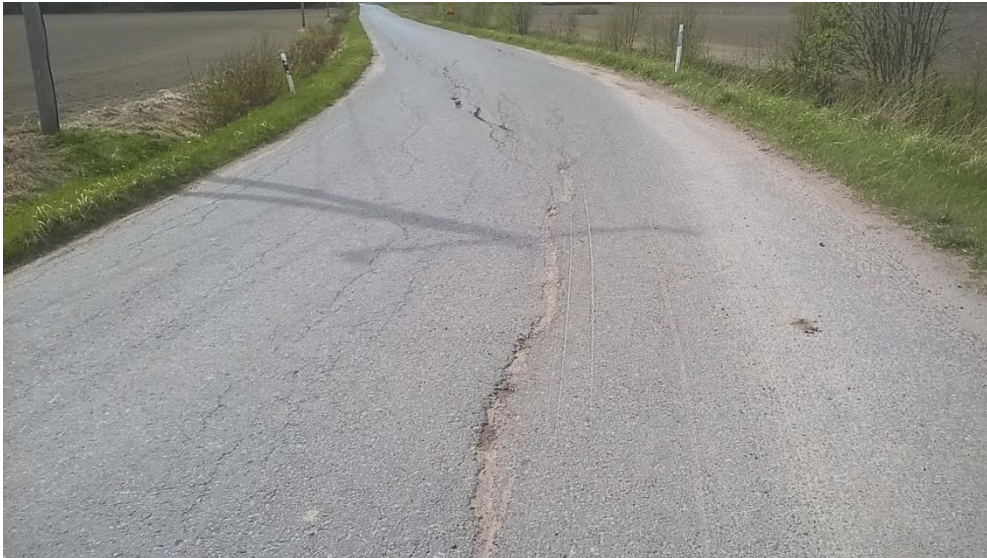
Kuva 28 Routahalkeama tien keskellä (Elina Lätti 2015)
