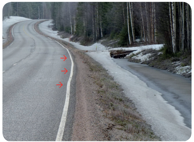
Mikäli veden virtaus estyy pitkään, imeytyy vesi tierakenteeseen aiheuttaen esim. routaheittoja. (Kuva: Timo Saarenketo)
