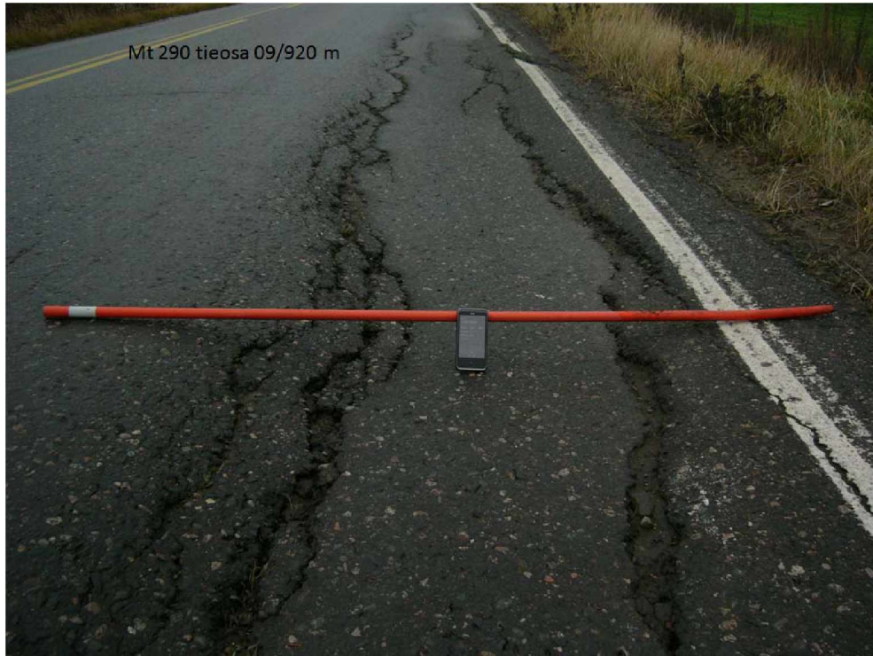
Kuva 32. Sivuttaisheilahduskohta maantiellä 290 tieosalla 9 kohdassa 920m suunnassa 1. Oikea ajoura on painunut melko paljon. Painuma on useita kymmeniä metrejä pitkä ja muistuttaa hiukan reunapainumaa, mutta oikea reuna ei ole painunut yhtä paljon kuin uran kohta. (P. Virtala, 2011).
