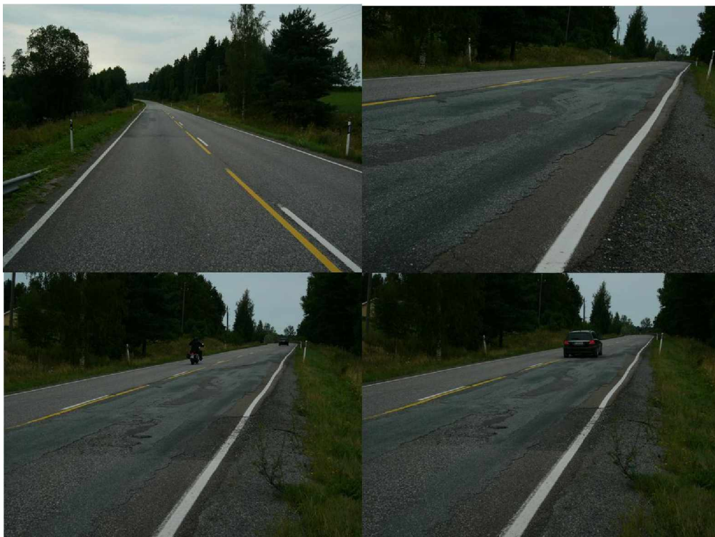
Kuva 37. Sivuttaisheilahtelua aiheuttava kohta maantiellä 112 tieosalla 1 kohdassa 5300–5330. Pinnan korkeusvaihtelut eivät näy valokuvassa kovin hyvin.
