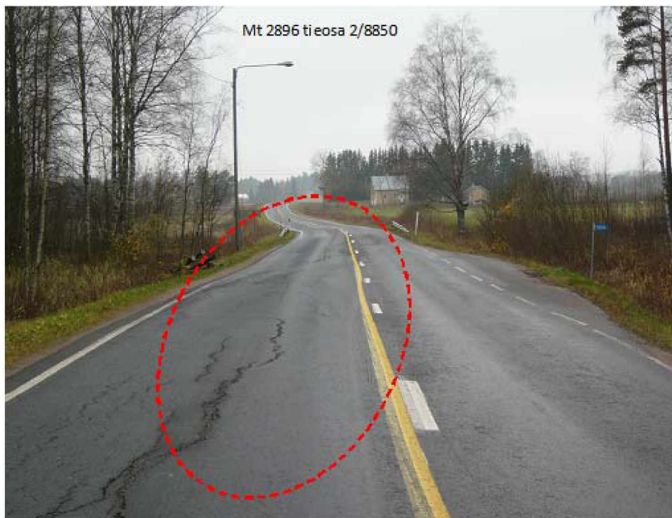
Kuva 29. Sivuttaisheilahduskohta maantiellä 2896 tieosalla 2 kohdassa 8850 suunnassa 1. Heilahduskohta oli helposti tunnistettavissa ja raskas ajoneuvo heilahtaa siinä selvästi. Haitallisuutta kuvaa sekin, että ajolinjat siirtyvät keskelle päin. (P.Virtala, 2011).
