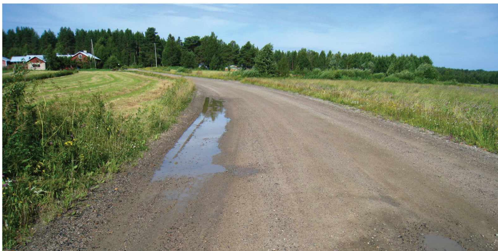
Kuva 4. Reunapalle estää veden poistumisen ja vaurioittaa pintaa.
