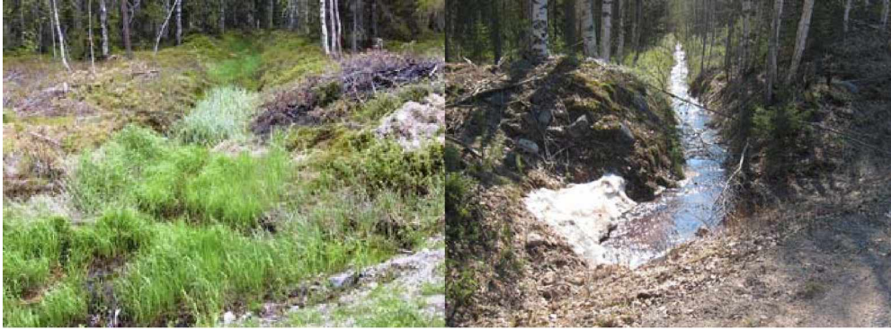
Kuva 35. Tukkeutunut ja toimiva laskuoja.
