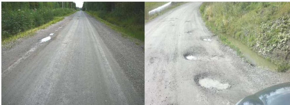
Kuva 14. Korkea piennar eli reunapalle estää pinnan kuivatuksen ja aiheuttaa vaurioita. Vesi seisoo sivuojassa tukkeutuneen liittymärummun takia, jolloin rakenteeseen imeytynyt vesi reikiinnyttää tienpinnan.
