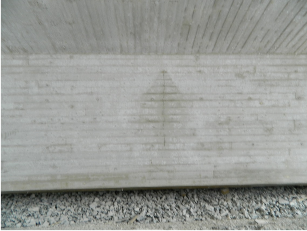
Kuva 1. Kuvassa on päätypalkin halkeama sillan aukon puolella. Halkeama on syntynyt jännittämisen jälkeen ennen sillan käyttöönottoa.
