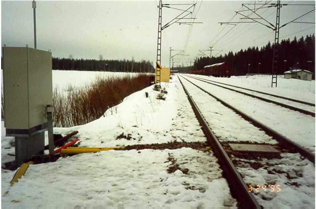
Kuva 9. Vuotojenilmaisain järjestelmä (VR Transpoint. 2011).
