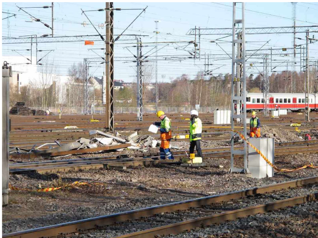
Kuva 14. Helsingin ratapihalle suistuneen lähijunan aiheuttamia vaurioita korjataan. (Kuva: Pertti Tapola.)
