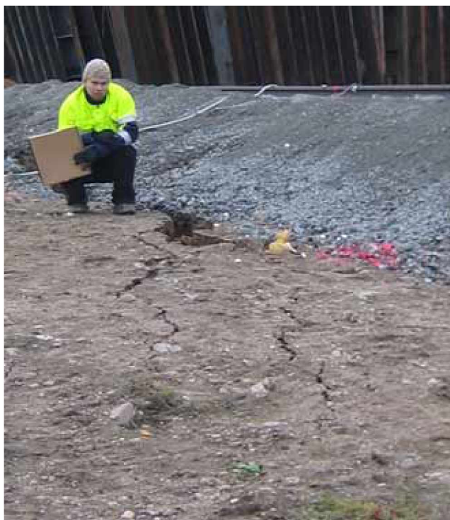
Kuva 85. Sorrutuskokeen päätutkija Juho Mansikkamäki ja liukupinnan sijainnista kertovan halkeaman pää.
