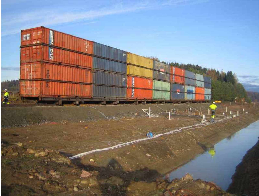
Kuva 40. Koealue ennen kuormauksen aloittamista. Datakaapelit erottuvat kuvassa valkoisina johtoina.
