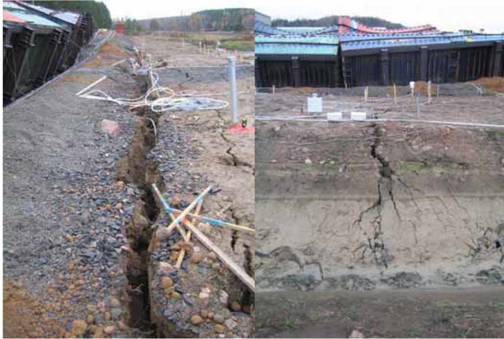
Kuva 47. Vasemmalla penkereen juureen haljennut railo, oikealla ojaluiskaan muodostunut poikittainen halkeama (toisen ja kolmannen vaunun välin tasalla).
