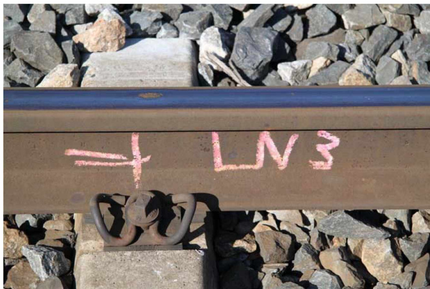
Kuva 55 Kiskon varteen tehty merkintä ultraäänitarkastuksessa havaitusta vikaluokan 3 viasta.
