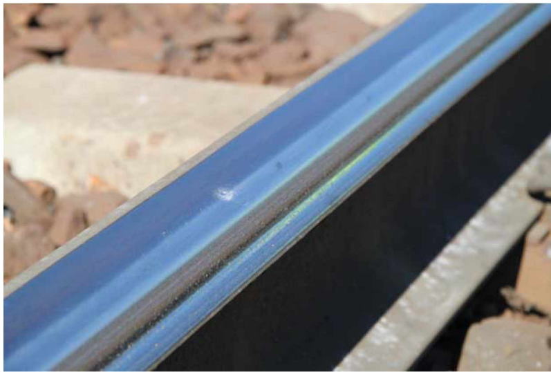
Kuva 27 Voimakasta sivukuluneisuutta kaarten ulkokiskossa.
