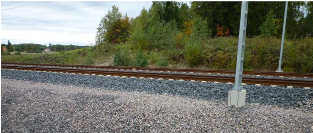
Kuva 2.12. Esimerkkikuva tukikerroksesta Oikoradalla liikennepaikkavälillä Mäntsälä–Sipilä.
