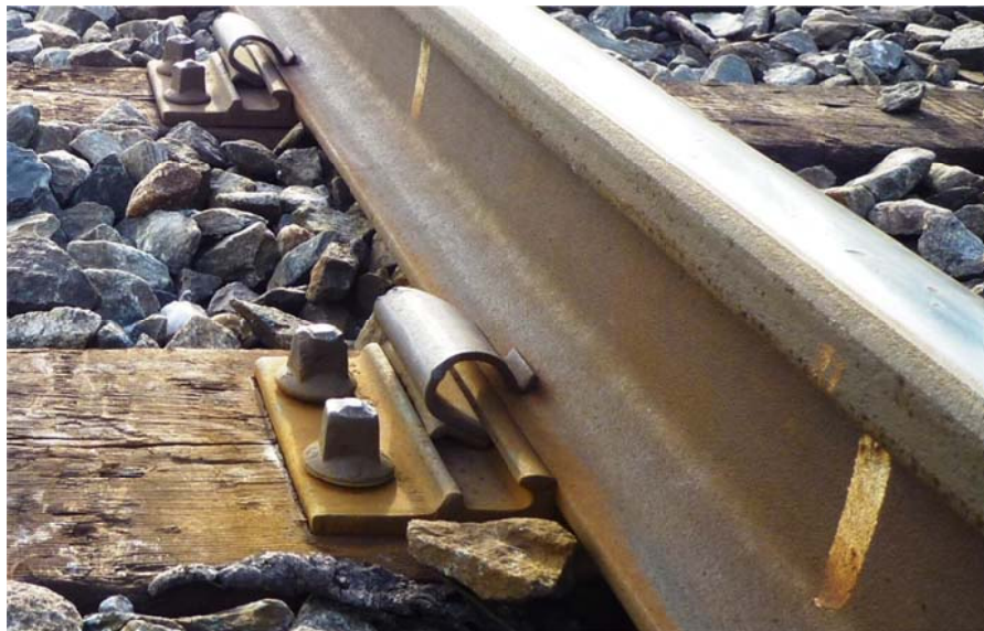
Kuva 2.5. Esimerkkikuva Suomessa käytössä olevasta Hey Back -kiinnityksestä puuratapölkkyyn.
