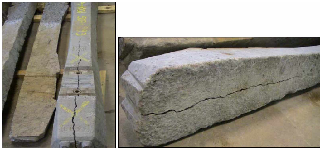
Kuva 12. Pituussuuntaan haljenneita ratapölkkyjä.
