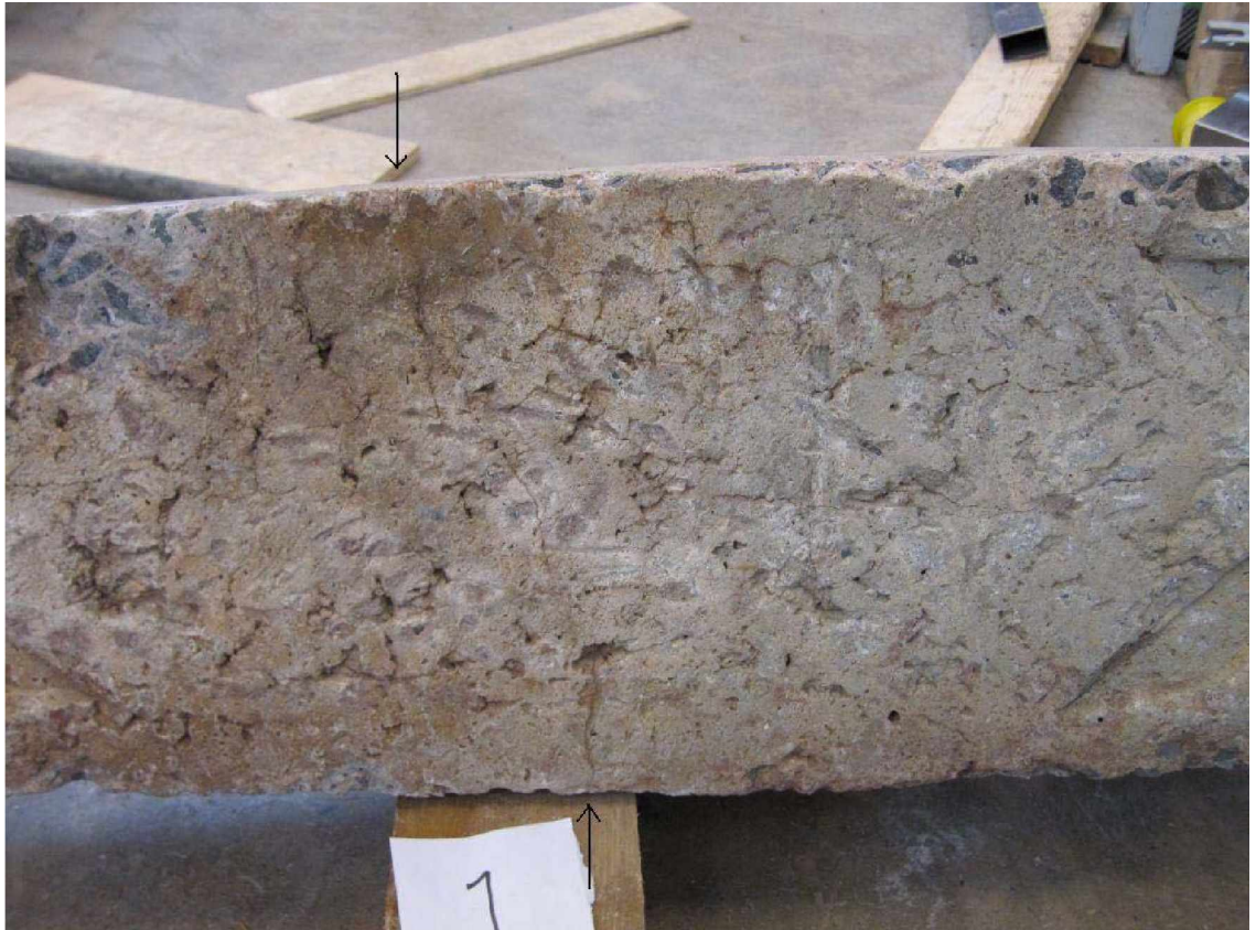
Kuva 51. Ratapölkkyssä ollut pystysuuntainen halkeama, joka pystyttiin havaitsemaan pölkyn alapinnasta.
