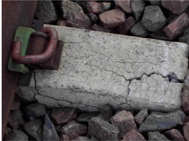
Kuva 5.9 Tyypillisiä halkeamia ratapölkyn päässä. Luokka 1 ”punainen” (Banverket 2010).
