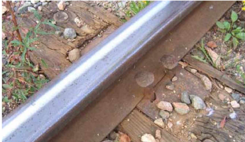
Kuva 6.3 Ratapölkkyyn tunkeutunut aluslevy, jonka seurauksena kiskon kiinnitys on löystynyt (Tunninen 2007).
