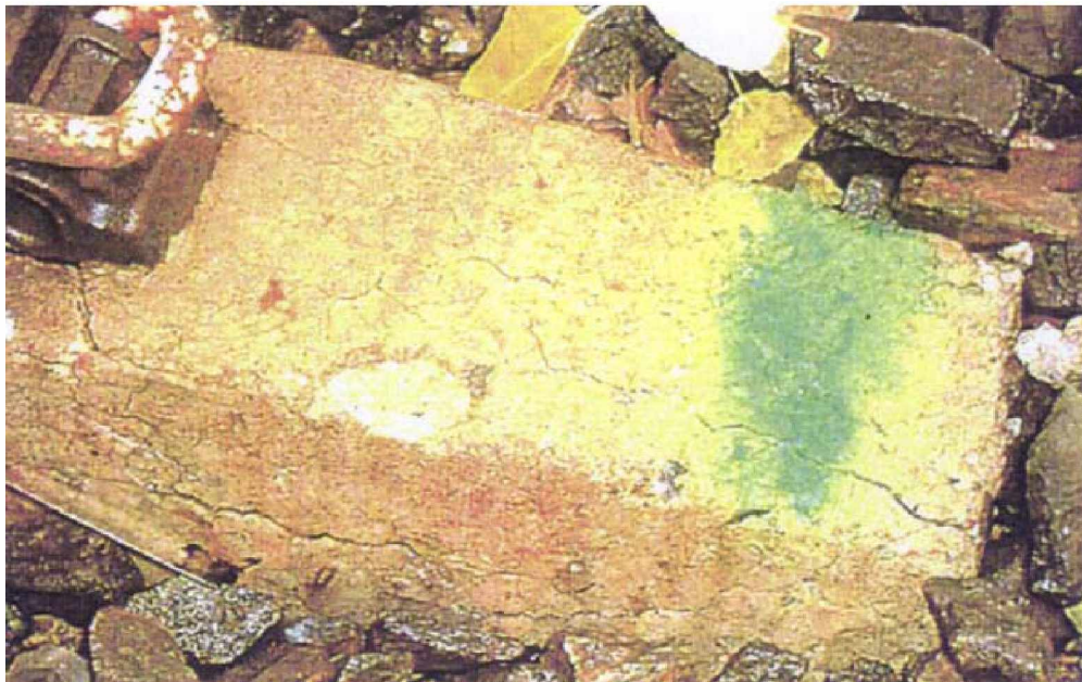
Kuva 5.8 Ettringiitin aiheuttamaa halkeilua betoniratapölkyissä Ruotsissa (Sahu & Thaulow 2004).
