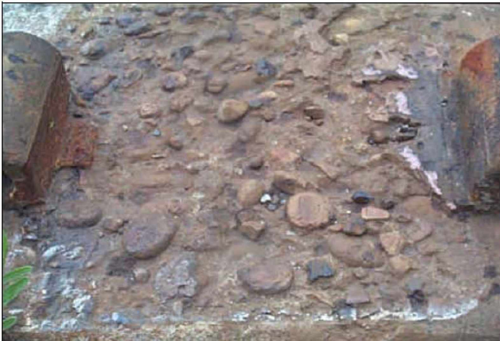
Kuva 5.17 Sementtipasta on kulunut pois jättäen jäljelle kovemman kiviaineksen (Zeman et al. 2009b).
