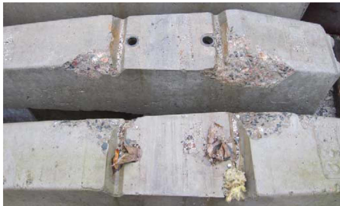
Kuva 5.14 Tuentahakun vaurioittamia ratapölkkyjä.
