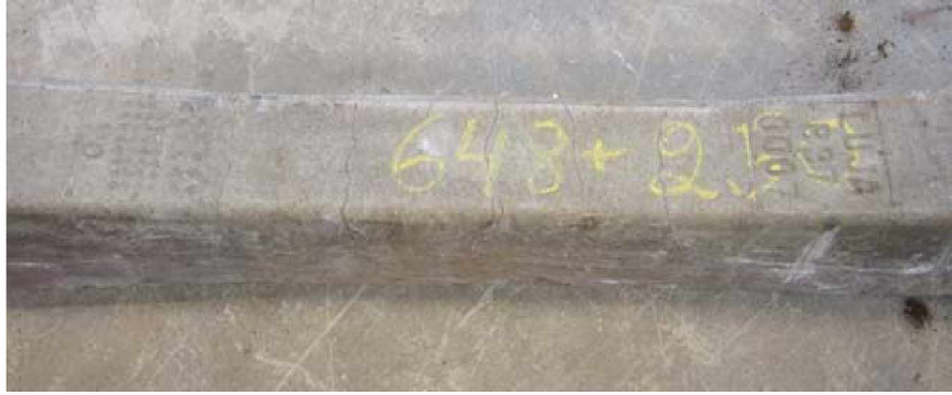
Kuva 5.1 Raiteessa halkeillut ratapölkky.
