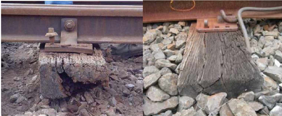
Kuva 6.2 Vasemmalla puun lahoamisesta kärsivä ratapölkky ja oikealla pölkyn pään halkeilusta kärsivä ratapölkky (Manalo 2011).
