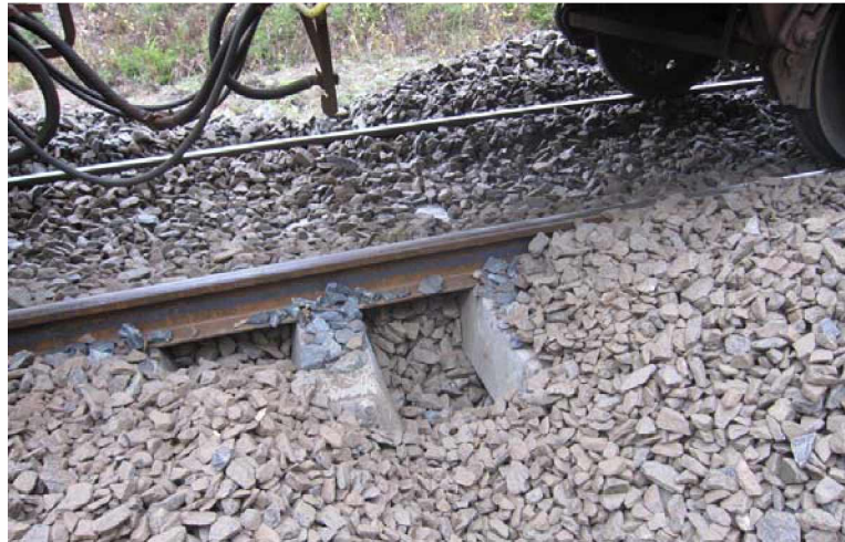
Kuva 5.15 Sepelin seulonnan jälkeinen tilanne, jossa yksittäisten ratapölkkyjen päiden alta puuttuu tuenta lähes täysin.
