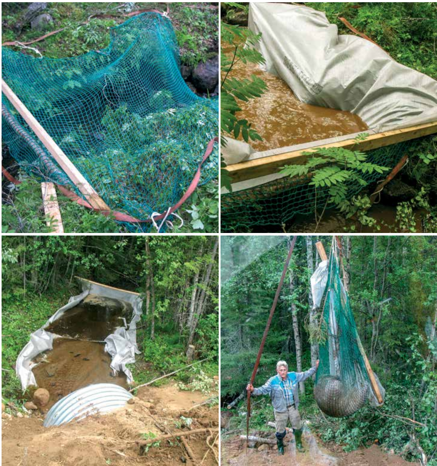
Kuva 43. Mikäli ylitysrakenne perustetaan uomaan, jossa on merkittäviä ympäristöarvoja (esimerkiksi jokihelmisimpukka) ja johon kaivuuedet johdetaan suoraan, on käytettävä sedimentin pidättimiä. Oheisessa kuvasarjassa (SCA, www.trafikverket.se/remibar ) on ruotsalainen menetelmä kiintoaineksen keräämiseksi. Ennen kaivuutöitä uomaan asennetaan vahva kuormaverkko puutukiin ja nostoliinoineen (ylävas). Rumpupaikan ja keräimen välinen uomanosa katetaan geotekstiilillä (alavas). Töiden jälkeen sedimenttipidättimeen kertynyt aines nostetaan uomasta ja läjitetään haitattomaan paikkaan (alaoik).
