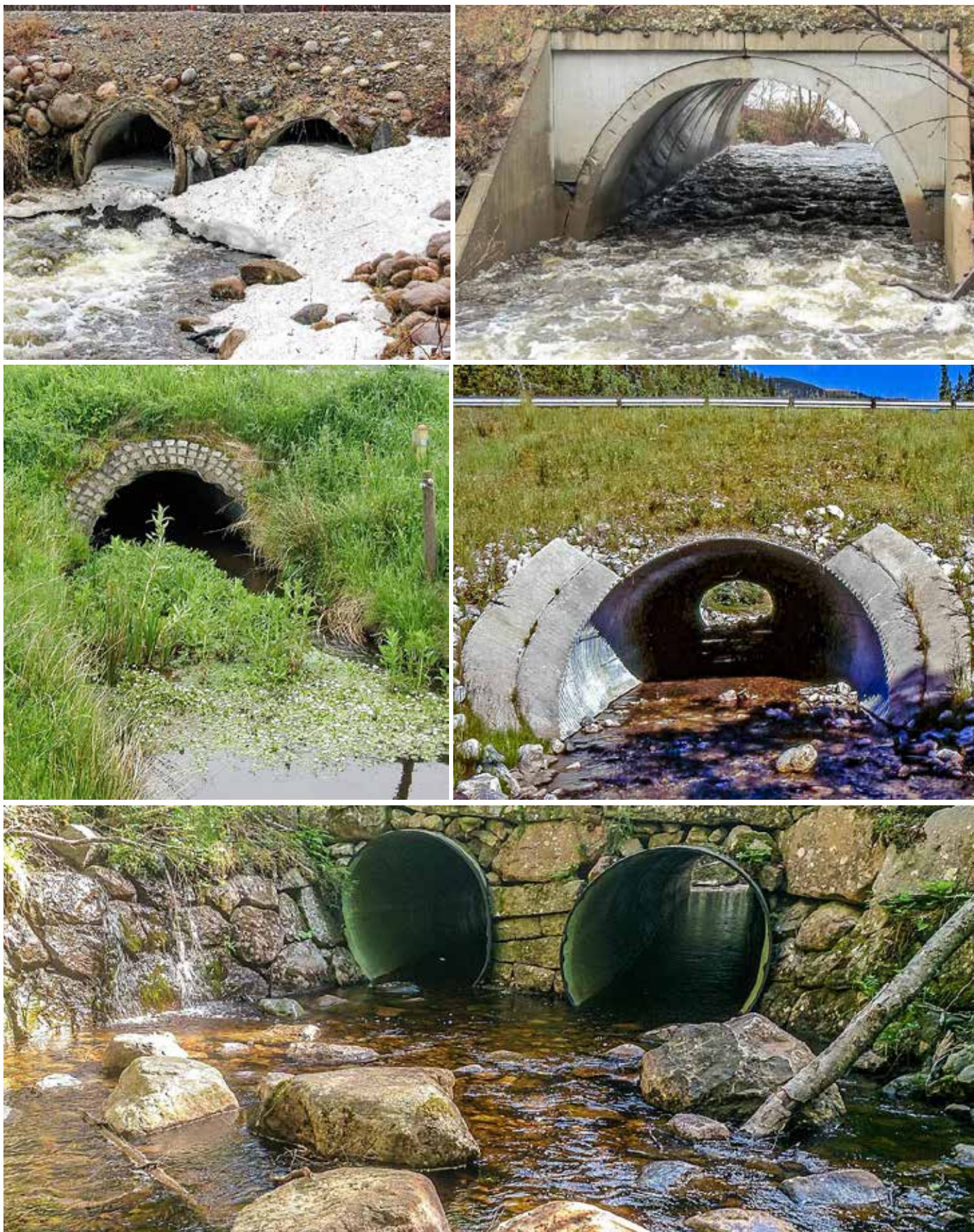
Kuva 65. Rumpurakenteiden päätyjen ja sivuluiskien vahvistaminen on erityisen tärkeää helposti erodoituvassa maaperässä. Karnjargajoen rumpuylyitys (ylävas) on esimerkki lajittuneeseen maaperään huonosti asennetusta, kun taas Ala-Seitakkojen kaarirumpu (yläoik) hyvin asennetusta rakenteesta.
