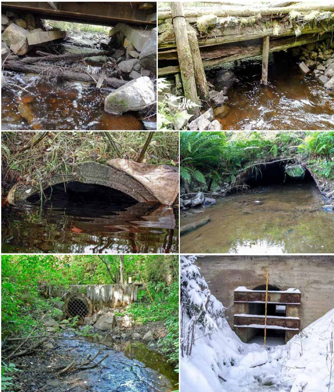
Kuva 55. Huonosti hoidetut ylitysrakenteet rikkoutuvat helposti ja aiheuttavat ympäristö-, kantavuus- ja kuivatusongelmia (yläkuvat). – Pehmeään maaperään asennetut rakenteet painuvat vähitellen liian syvään (keskellä). – Välppä- ja muut sulkurakenteet vaativat säännöllistä puhdistusta sekä riittävän harvaa säleikköä (alakuvat).
