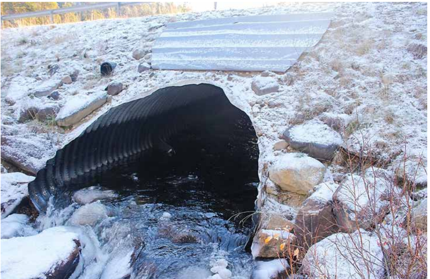
Kuva 59. Puksaljoen ylitysrakenne Utsjoella on Suomen pisimmälle kehitetty rumpurakenne. Se on ovaalinmuotoinen teräsrumpu, jonka pohjassa on kolme teräslamellia. Niillä ei säädellä tässä ratkaisussa veden virtausta, vaan ankkuroidaan pohjakatteena käytetty luonnonkiviaines paikoilleen. Suppo- ja paannejään hallitsemiseksi rummun molempiin päihin teetettiin rekkojen peitekan- kaasta suojaverhot, joiden päälle lingotaan eristystä lisäävä lumikate.
