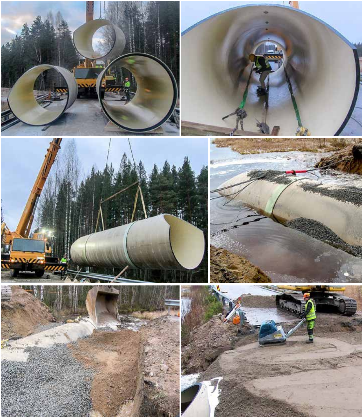
Kuva 40. Mansikkaheton putkisilta Jyväskylän Tikkakoskella asennettiin vuonna 2014. Se on Suomen ensimmäinen vesistöön asennettu yleisen tien komposiittiputkisilta (Ø 2400 mm). Kuvasarja esittää elementtien purkamisen, kokoamisen, noston, kallistuksen mittauksen, sepelitäytön ja tiivistyksen.
