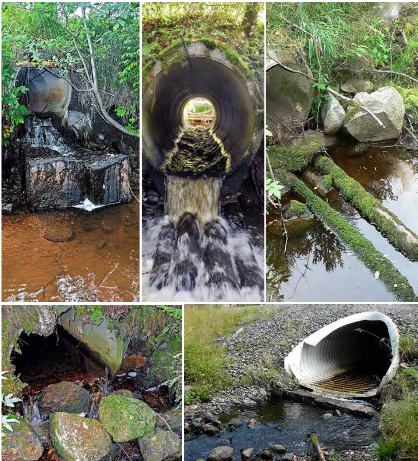
Kuva 46. Rummusta purkautuva vesi pyrkii syövyttämään rakenteen alapään "eteisaluetta". Sen ehkäisemiseksi rummun alla ja sivuilla käytetään usein puisia, kivisiä tai betonisia suojarakenteita. Ne kuitenkin estävät vesieläimen pääsyyn rumpurakenteeseen tai vaikeuttavat sitä merkittävästi.
