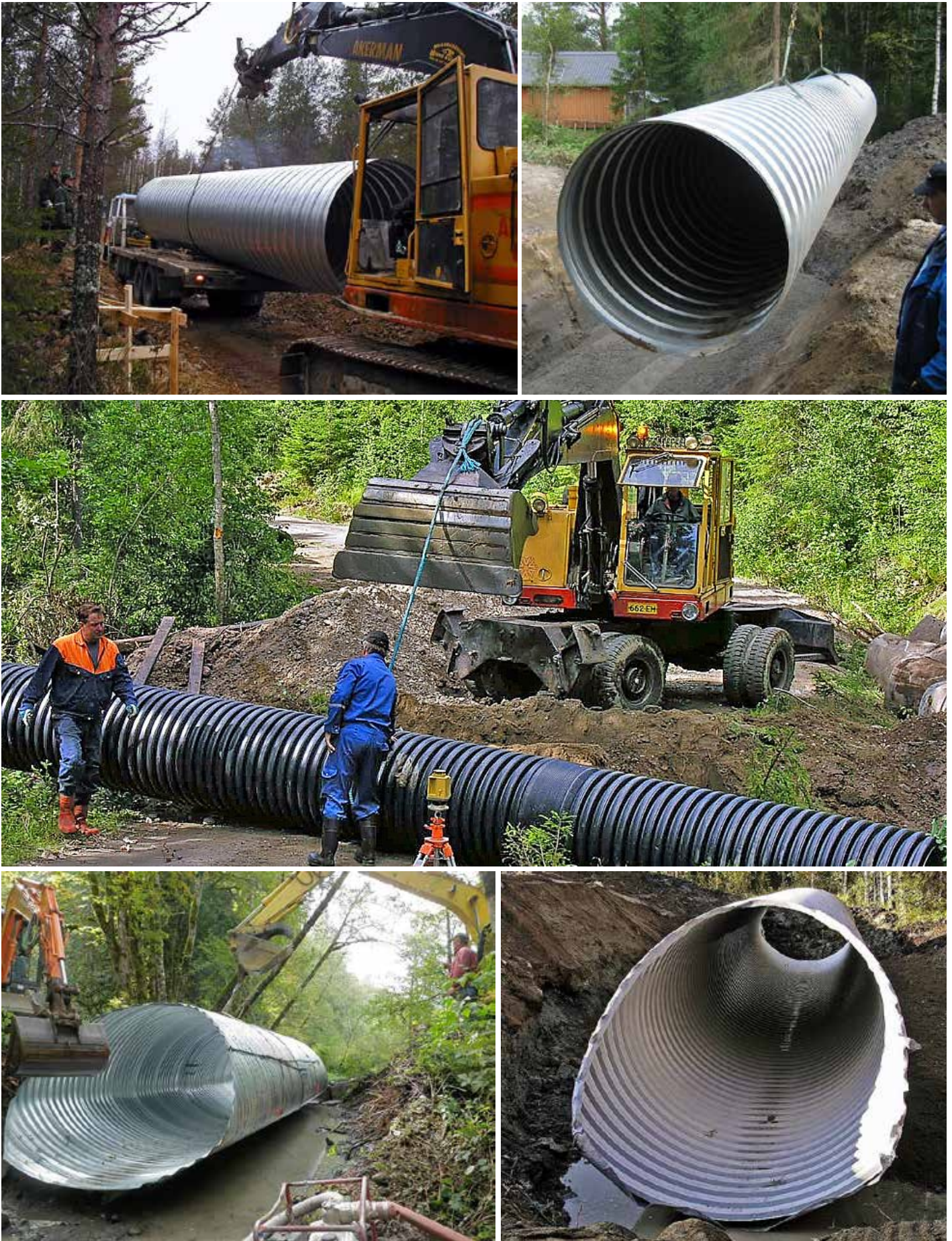
Kuva 39. Ylitysrakenteen asentamisessa voidaan hyvinkin suunnitelma turmella. Ympäristöllisten tavoitteiden toteutuminen edellyttää riittävää ekologista asiantuntemusta ja valvontaa toteutusvaiheessa. Virheiden myöhempi korjaaminen on kallista ja hankalaa. Figure 39. Even an excellent plan can be ruined during the installation of a crossing construction. Realization of environmental targets demands sufficient ecological expertise and supervision in the field. Fixing the mistakes afterwards is expensive and laborious.
