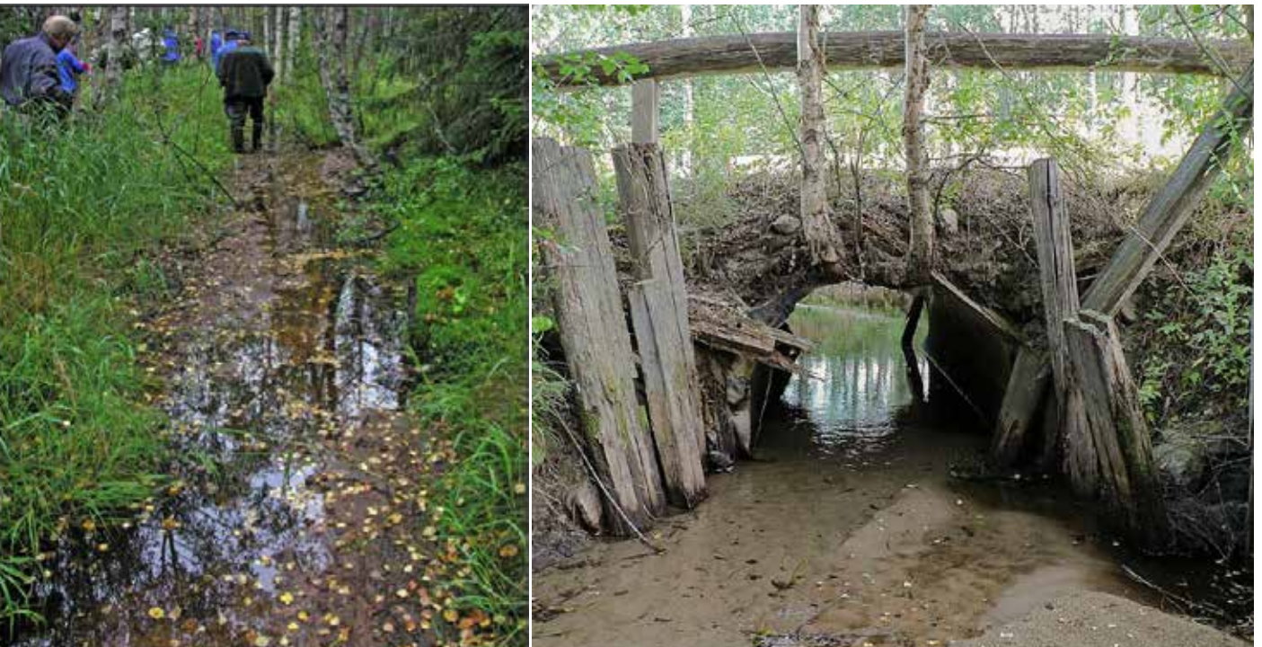
Kuva 26. Ojien, uomien ja ylitysrakenteiden kaivaminen sopimattomaan maaperään ilman ojkatkoja ja muita vesiensuojelutoimenpiteitä tuhoaa helposti koko virtavesiympäristön. Tieojienkin kaivamisessa on tärkeää laskeuttaa sedimentti ennen sen huuhtoutumista vesistöön. – Hiekan täyttämä sivu-uoma (vas) ja hienojakoisen sedimentin turmelema ylitysalue (oik).
