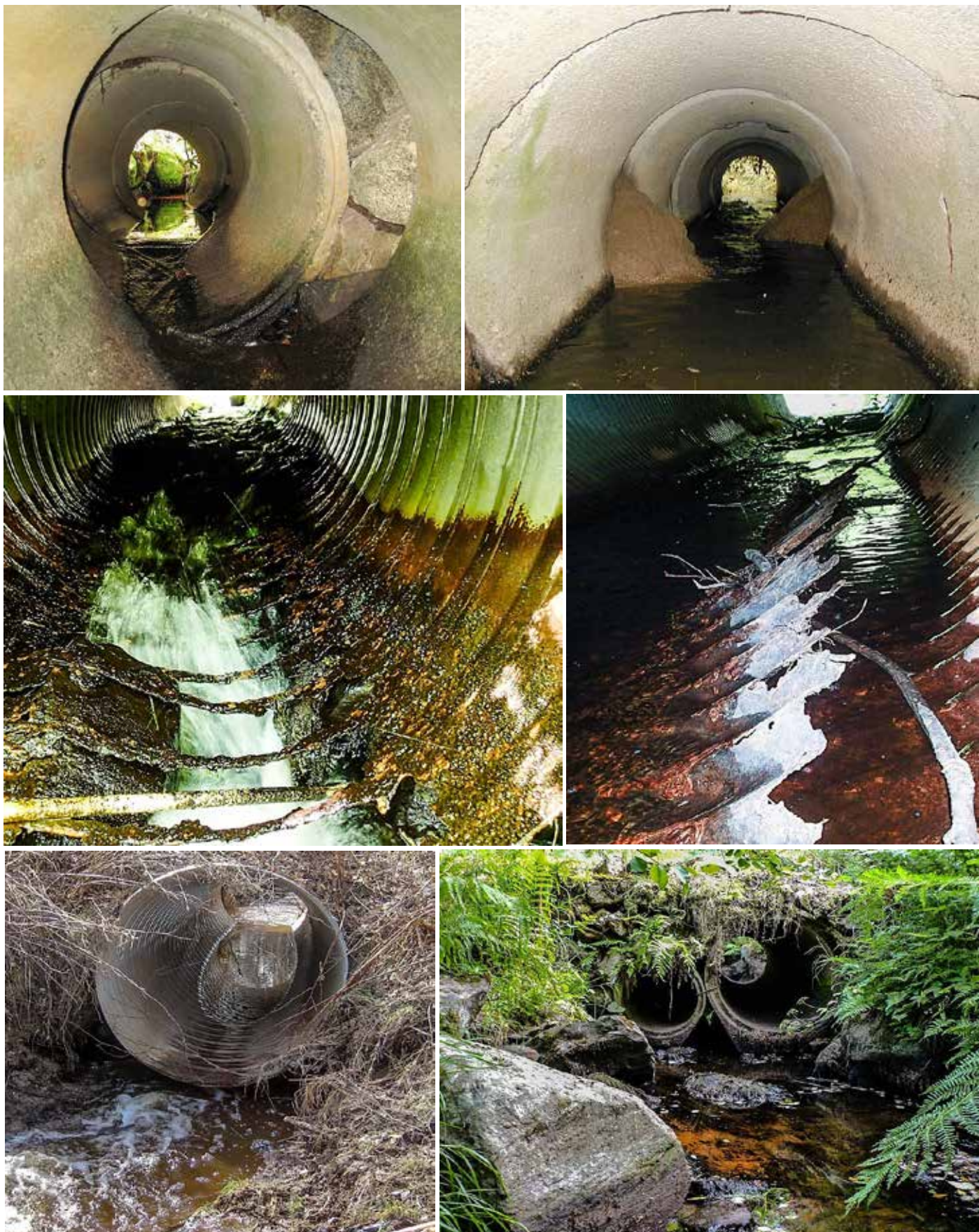
Kuva 54. Routa liikuttaa ja rikkoo huonosti perustettuja rumpuputkia, jolloin täyttömaat pääsevät valumaan putken sisään (yläkuvat). – Pintakäsittelemättömät metallirummut ruostuvat nopeasti maamme happamissa vesissä (keskikuvat). – Vesi hakeutuu huonosti tiivistettyjen ja eristettyjen rakenteiden alle (alakovat).
