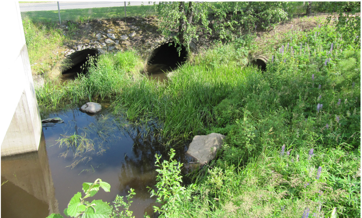
Kuva 10.4. Kulmalan Puistokadun siltarummut. Vuoden 2004 tulvassa vettä jouduttiin pumppaamaan myös tien yli. (Hämeen ELY-keskus 2014)
