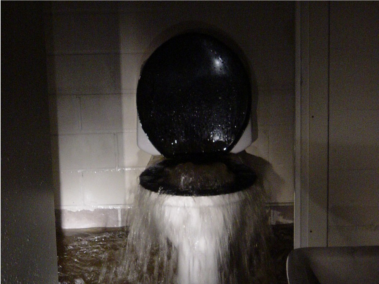
Kuva 10.1. Kellarikerroksen WC-pönttö tulvii Riihimäen tulvassa. (Kanta-Hämeen pelastuslaitos 2004)
