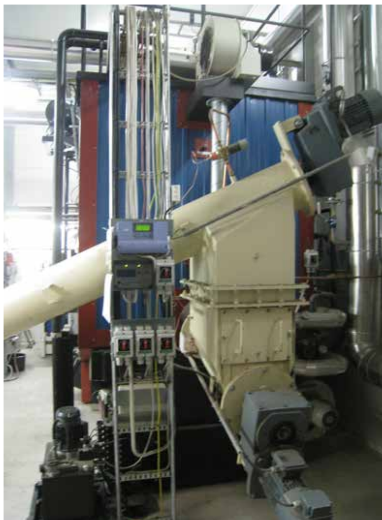
Taivassalon lämpölaitoksen pääkattilan nimellisteho on 1,2 MW. Vaalea vino nostoruuvi kuljettaa polttoainetta varastosta pesäruuville. Kuva: Terhi Ajosenpää
