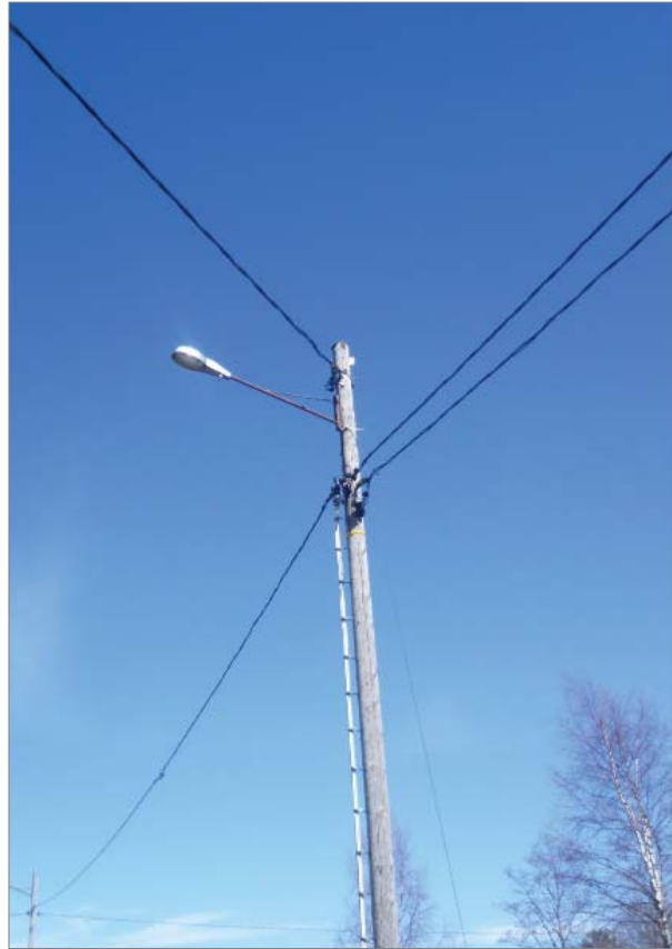
Sillan valaisimet ovat perinteisiä puupylvääseen asennettuja tievalaisimia. Valaistus on kunnan omistuksessa. Kuva Laura Soosalu
