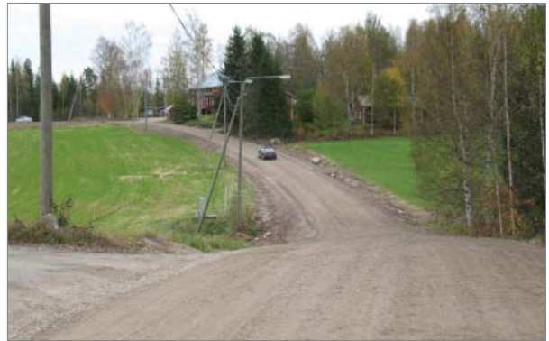
Lännestä kohti Seurataloa tien varret näkyvät siisteinä. Oikealla vastarinteessä on uusittu sivuojarumpu. Rummun vanhat sementtiputket ovat vielä tienpenkalla. Muovi katoaa näkyvistä heti, kun maan nurmettuu tulevana kesänä. Kuva Tapio Mård
