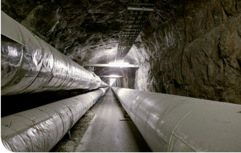
Kaukolämpöputkea Turun seudulla (Oy Turku Energia Ab, Esko Keski-Oja)
