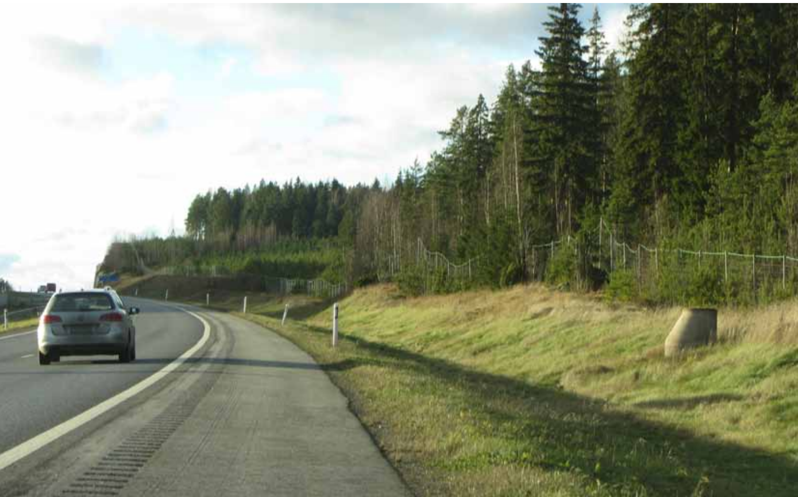
Kuva 18. Kaivot ulkoluiskassa heikentävät suistumisturvallisuutta.
