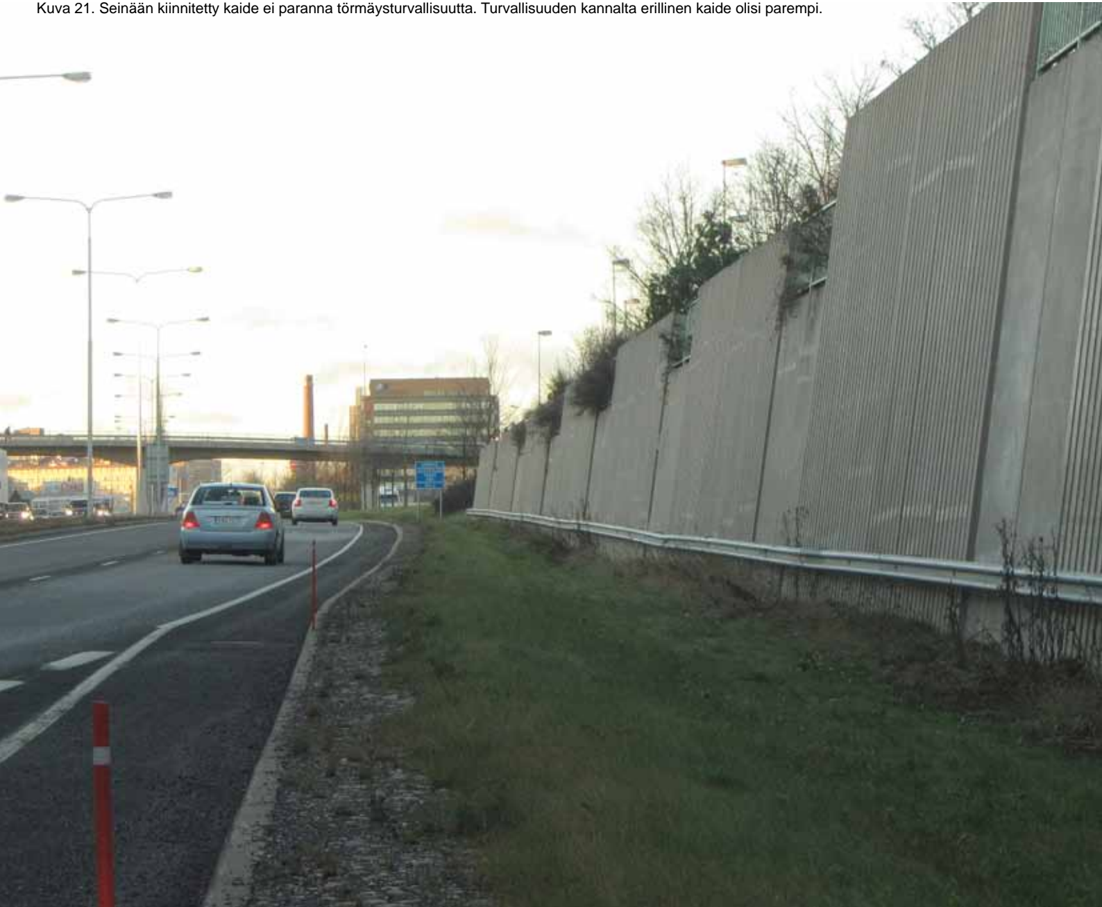
Kuva 21. Seinään kiinnitetty kaide ei paranna törmäysturvallisuutta. Turvallisuuden kannalta erillinen kaide olisi parempi.
