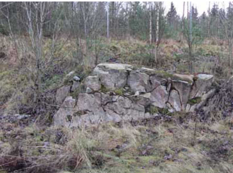
Kuva 14. Kallio ulkoluiskassa heikentää törmäysturvallisuutta.
