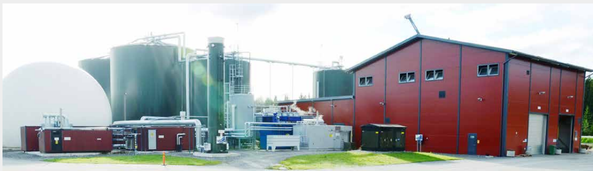
Kuopioon rakennettava biokaasulaitos on kokoluokaltaan ja toiminnaltaan vastaava kuin VamBio Oy:n biokaasulaitos Huittisissa. Kuva: VamBio Oy.
