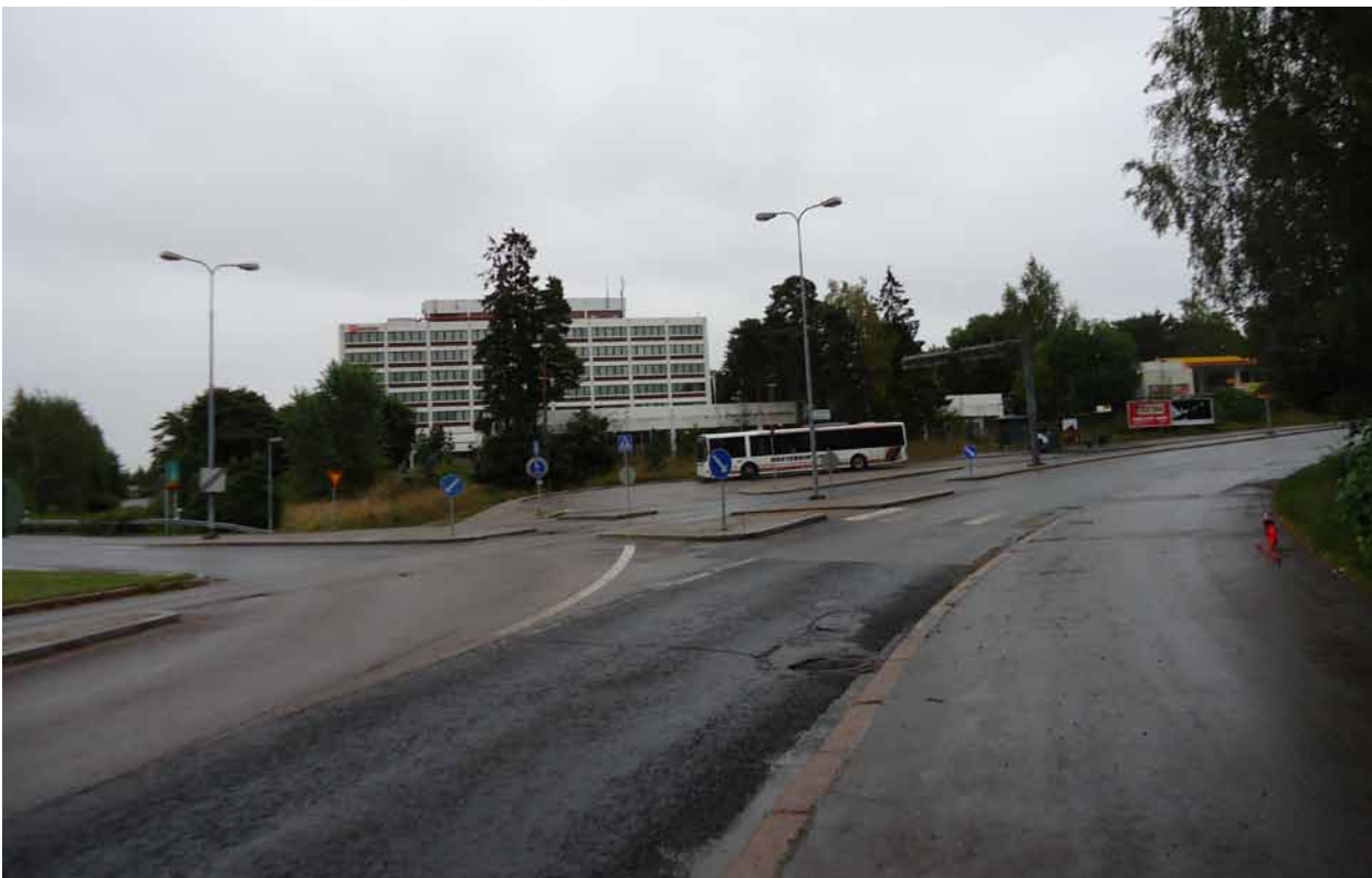
Kuva 30. Maastokohde Espoossa. Suojatiemerkit puuttuvat kokonaan tien oikealta puolelta ja tiemerkinnot ovat huonossa kunnossa. Kuvassa vasemmalla oleva suojatiemerkin ja suojatiemerkinnot päällysteessä. Suojatie on esimerkki huonosti erottuvasta suojatiestä.
