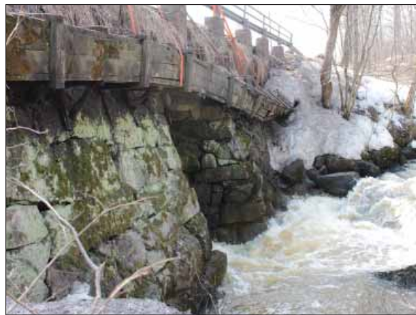
Sågbro yläjuoksulta kuvattuna. Kuvassa näkyy liinoilla kannateltu lahonnut puinen kaapelikotelo ja teräskaide. Teräskaitteen alapuolella erottuvat alkuperäiset kiviset kaidepilarit. Kuva Petra Kotro.
