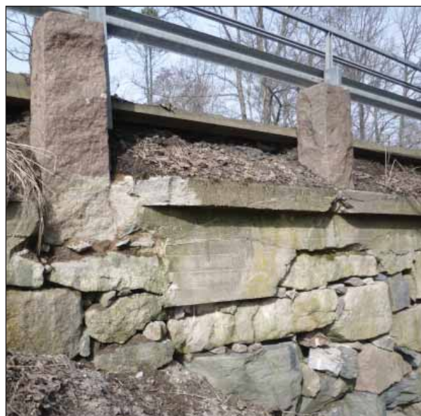
Sillan vaurioitunutta tukireunusta, joka on paljastanut graniittisen kaidepylvään. Kuva Laura Soosalu.
