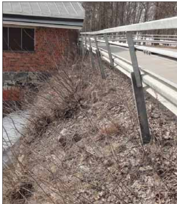
Qvarnbron sillan ja myllyrakennuksen pengertä. Vanhat graaniittiset kaidepilarit ovat jääneet heinän ja pensaiden sekaan ja yleisilme on epäsiisti. Kaide on vääntynyt ilmeisesti aurasluumen painosta. Luiska kaipaa siistimistä. Kuva Laura Soosalu.
