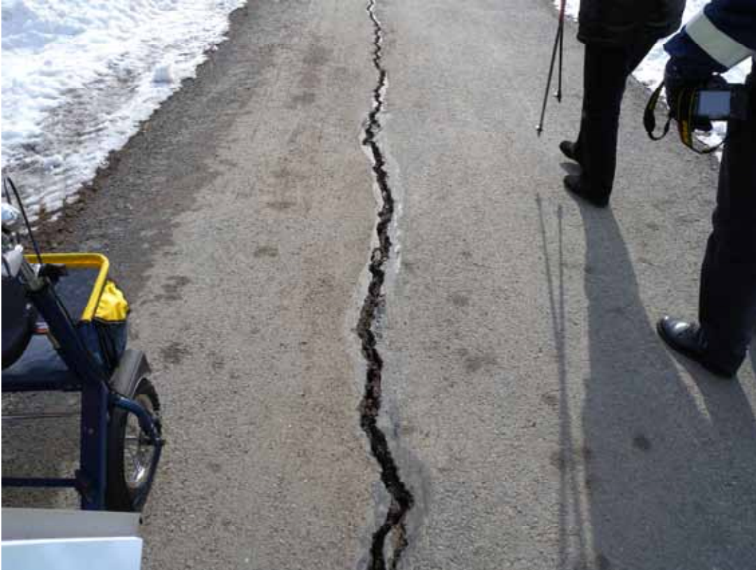
Kuva 8. Nivankadun kevyen liikenteen väylälle on tullut tänä keväänä routavaurioita.
