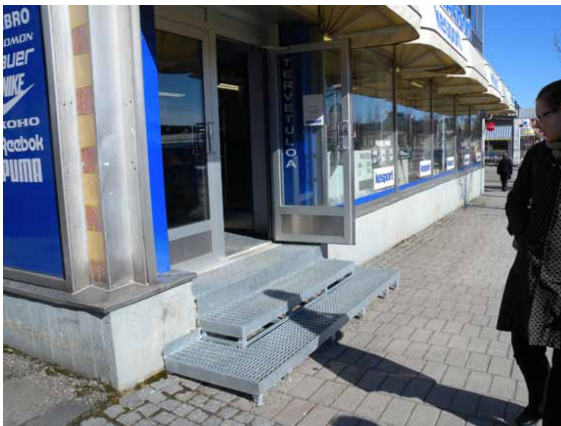
Kuva 1. Keskusta-alueen liikkeiden sisäänkäynneissä on paljon esteettömyyspuutteita. Useisiin liikkeisiin on esim. pyörätuolilla mahdotonta päästä edes avustajan kanssa.
