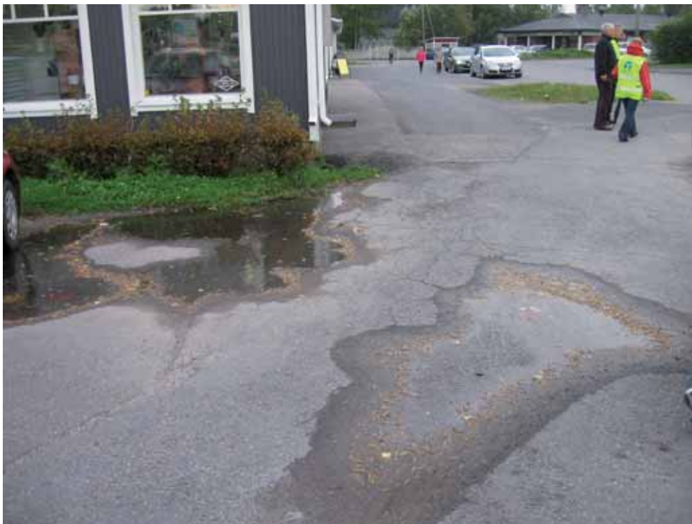
Kuva 28. Kevyen liikenteen väylillä ja jalkakäytävillä oli paikoin epätasaisuutta ja routavaurioita.
