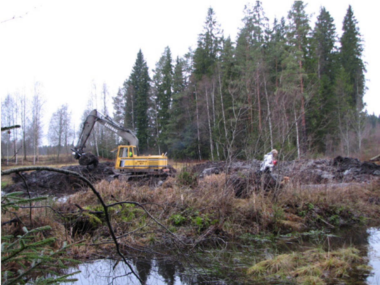
Kosteikon perustamistyöt käynnissä. Etualalle on jätetty aluksi kannas kaivamatta ja se avataan vasta kun taustan allas on kaivettu, ettei kaivamisen irrottama kiintoaine pääse kulkeutumaan uomaan ja vesistöön. Kuva: Anni Karhunen.
