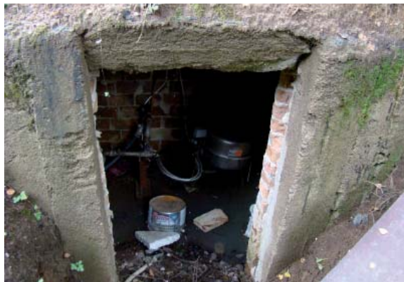
Kuopassa 3 oleva pumppuhuone pitäisi siivota ja kulkuaukko lukita.
