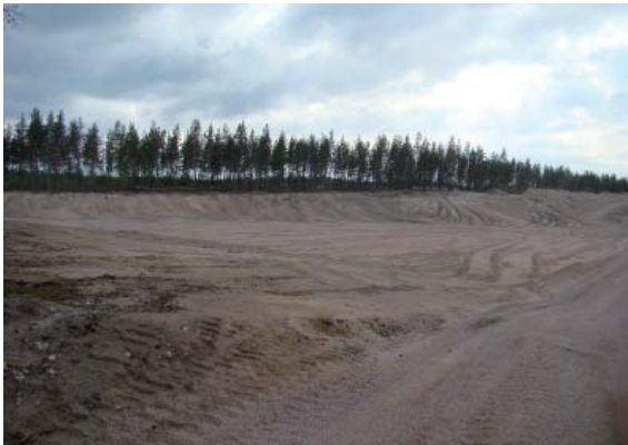
Kuopan 7 alue on muotoiltu hyvin, alueelle tulisi levittää pintamaata, jotta kasvillisuuden leviäminen nopeutuu.
