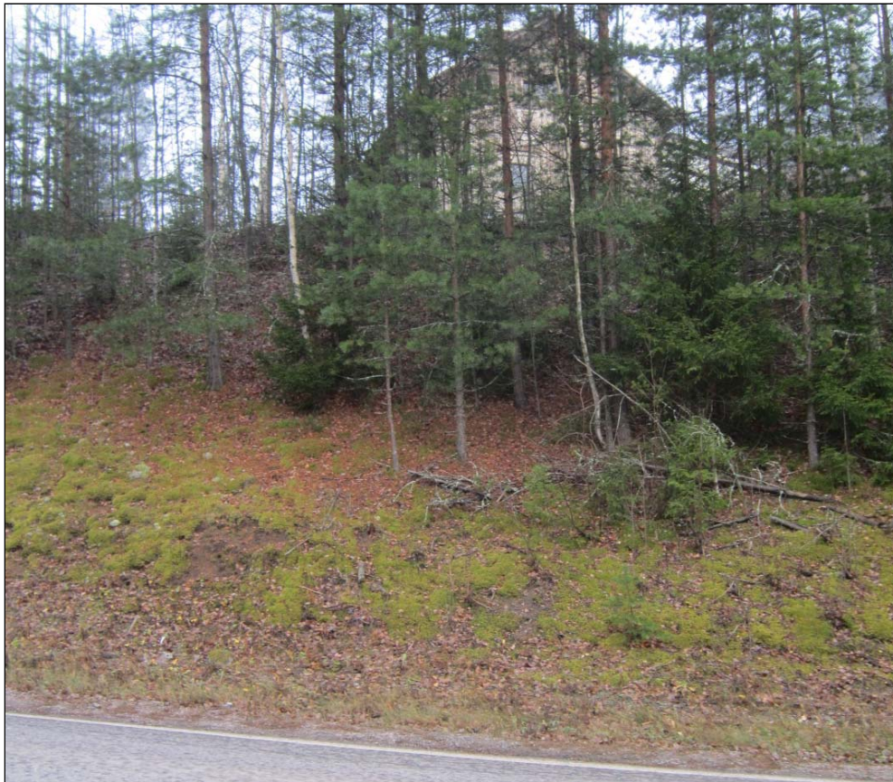
Kuva 13. Jyrkkää luiskaa ei ole mahdollista muotoilla uudelleen, jotta rinteän kantavuus ei heikkenisi.
