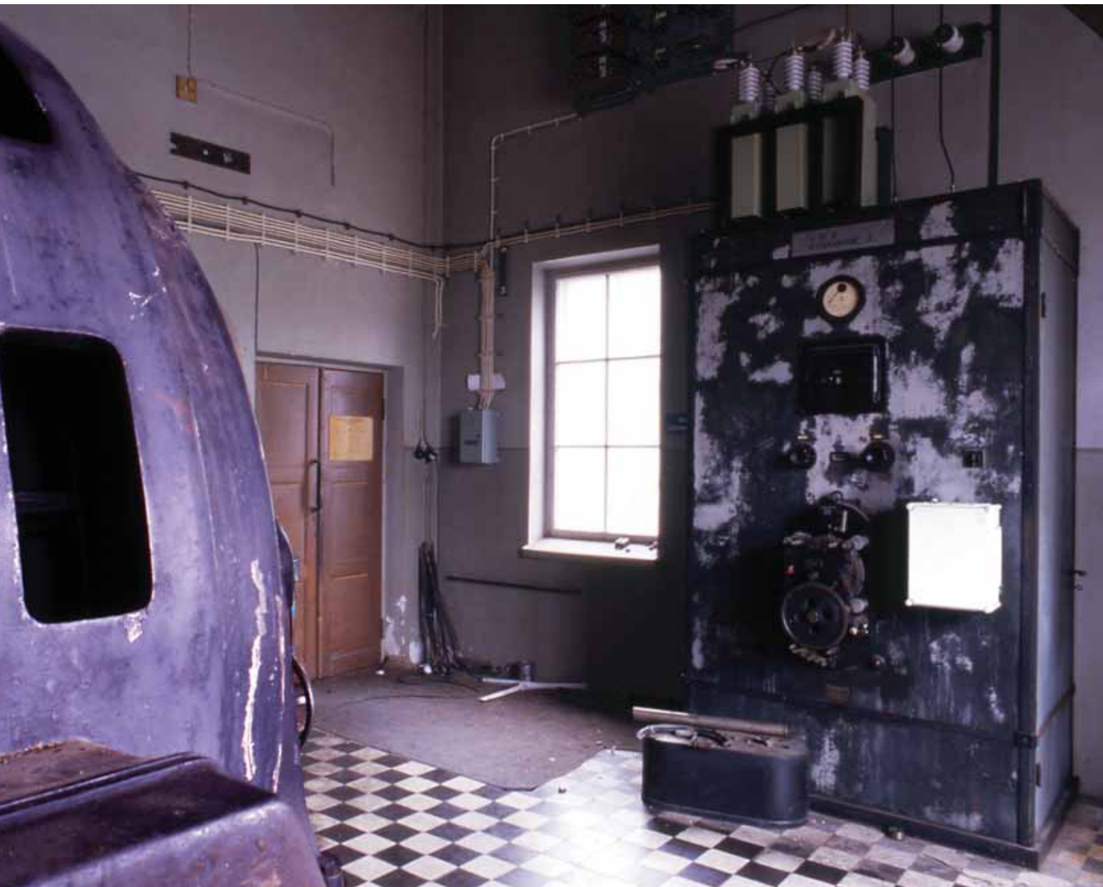
Kuva 28: Sisäkuva voimalaitoksesta. Kuvassa kolmivaihesynkronimoottori ja peltinen kojekaappi. Matti Huuhka 1998, Museokuva, MV.
