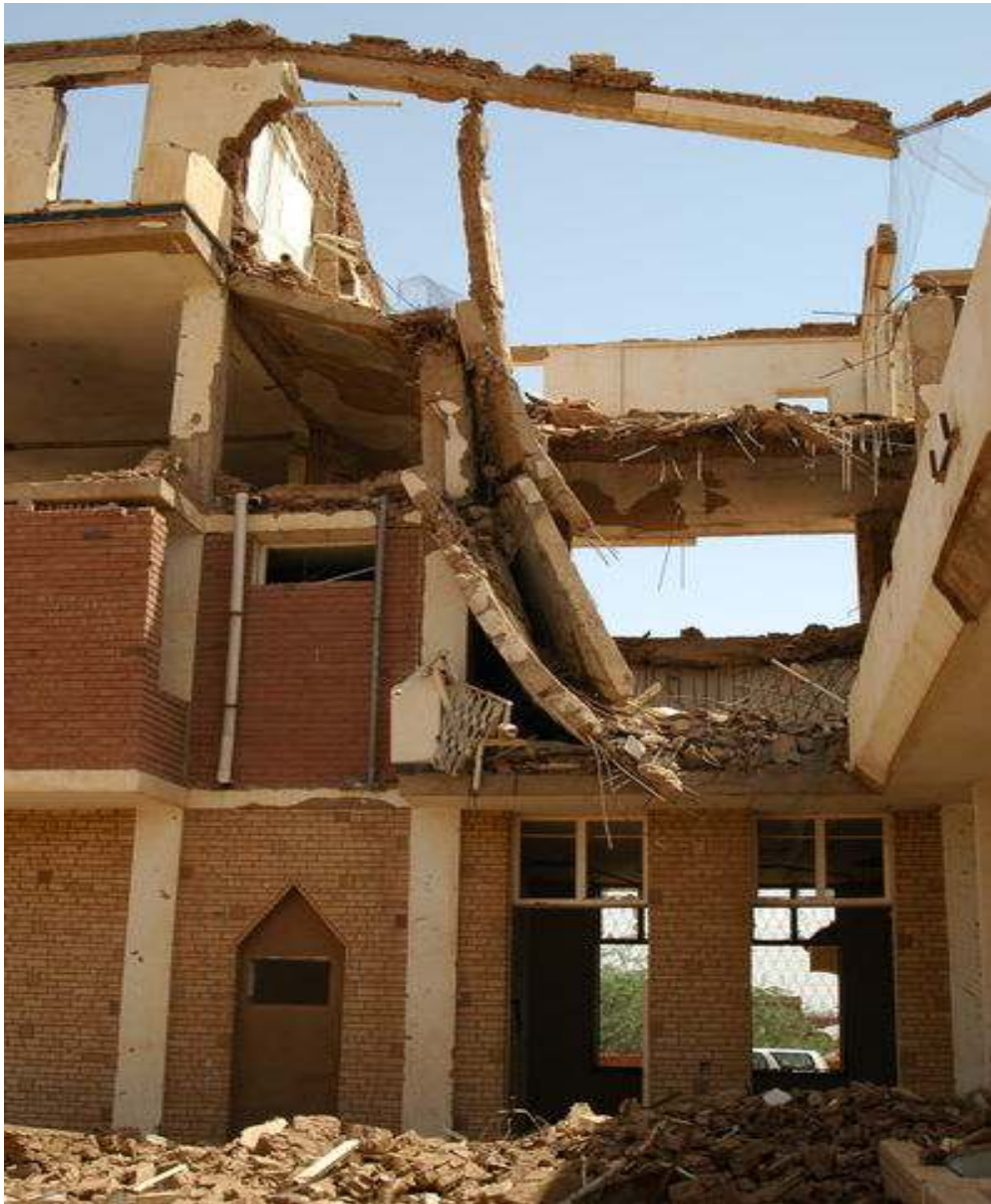
Kuva 3. Risteilyohjus on iskeytnyt rakennuksen katon lävitse.
