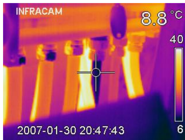
Kuva 30. Lattialämmitys verkoston jakotukissa on kylmälenkki (autotalli)
