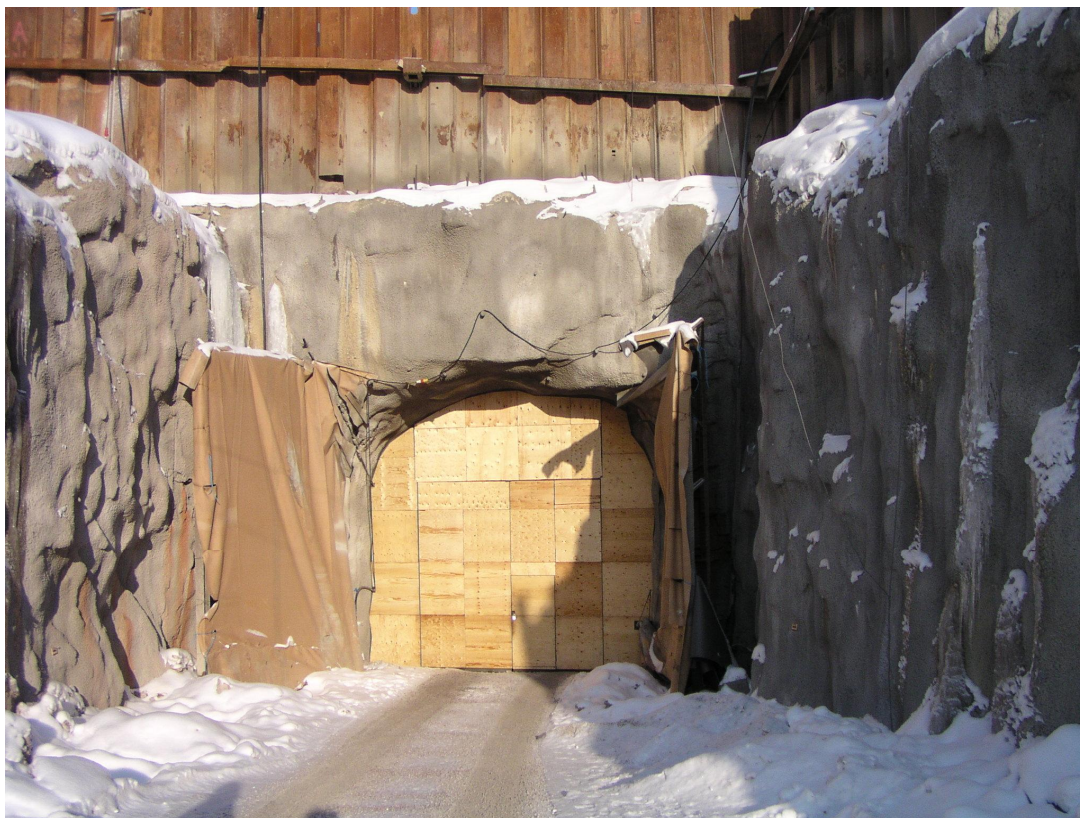
Kuva 1. Auki olevat louhintaurakan aikaiset ovet on korvattu rakennusurakan ajaksi tiiviimmällä ratkaisulla /7/.
