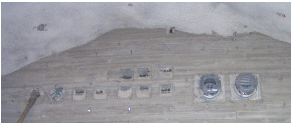
Kuva 17. Lämpimenokappaleita ei ole suojattu kunnolla ennen valua. /7./
