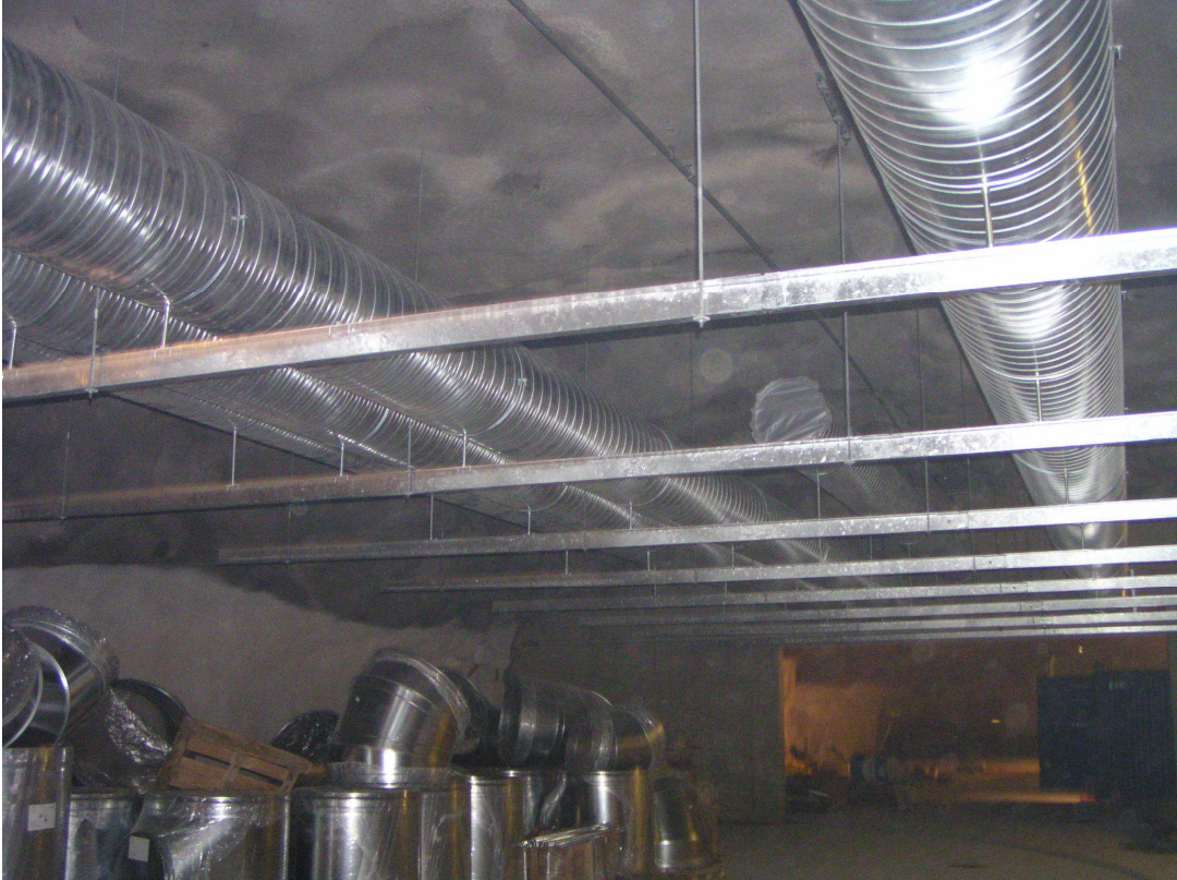
Kuva 3. Ilmastointirakenteiden osia hallin lattialla ja yhteiskannakkeilla /7/.
