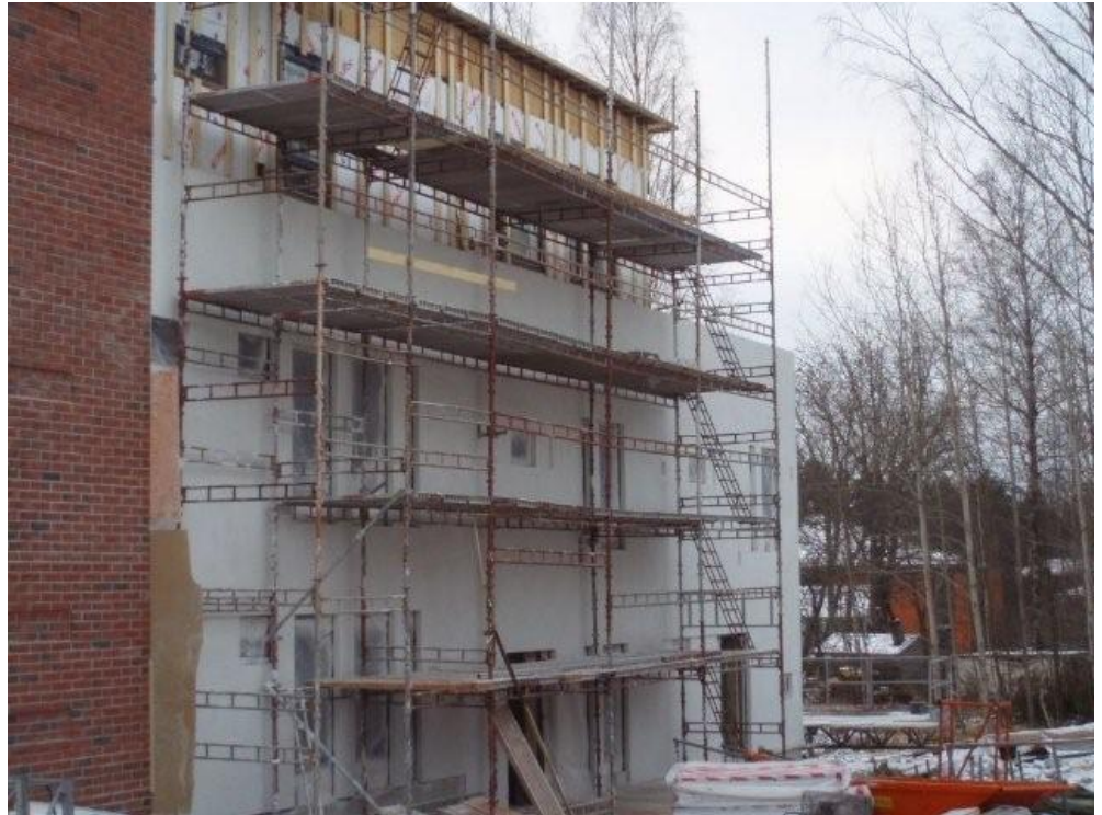
Kuva 1: Suojakaiteet ja jalkalistat puuttuvat telineistä /5./
