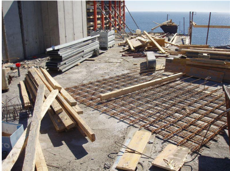
Kuva 3: Työturvallisuus vaarassa: kaiheet puuttuvat ja rojua siellä täällä /5./
