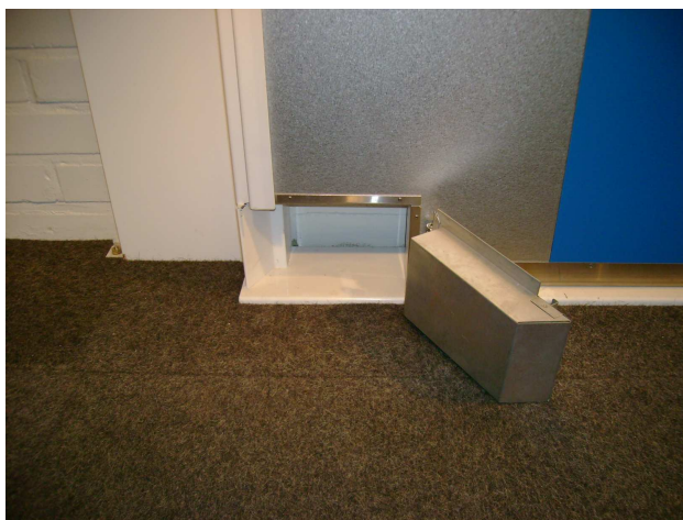
Kuva 4. Palonsammutusletkun läpivientiluukku ovesta
