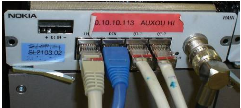
Kuva 45. Main unitin etupaneelikytkennät
