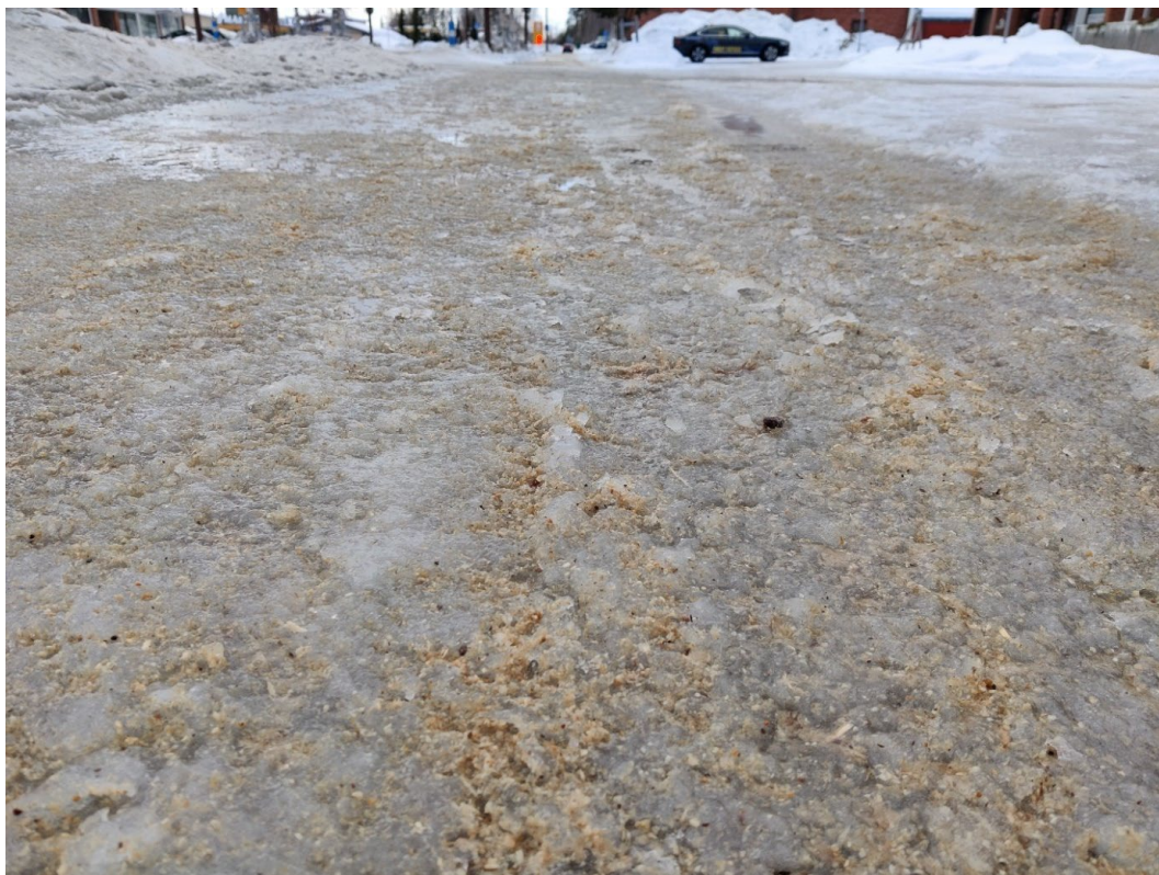
Kuva 35. 573 kävely- ja pyöräilyväylä, puru. Sahanpuru uponnut jäähän todennäköisesti auringon vaikutuksesta.
