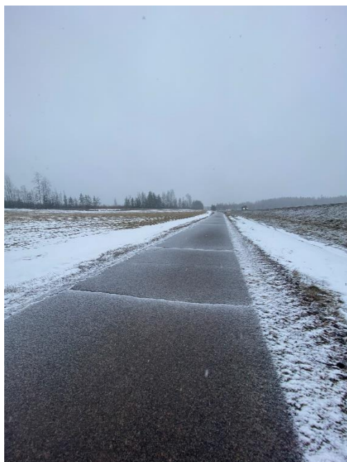
Kuva 53. Lahti–Orimattila-reitillä väylän kunto oli lumi ja räntäsateesta huolimatta pääosin olosuhteisiin nähden erittäin hyvä.
