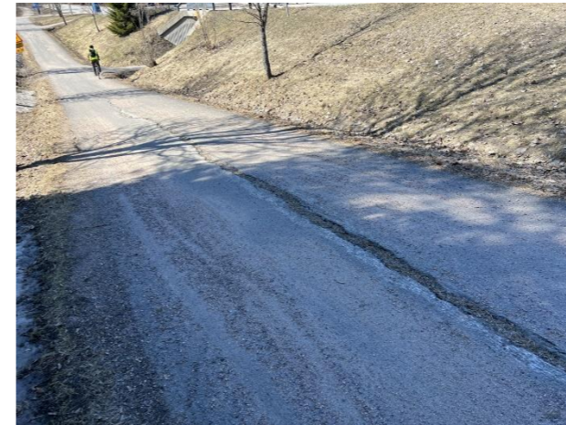
Kuva 26. Pituussuuntainen halkeama alamäessä Uudenkylän pääpyöräreitillä
