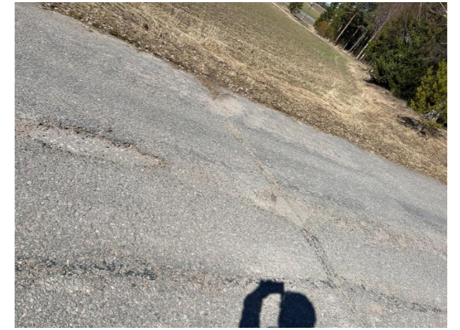
Kuva 27. Useita päällystevaurioita Orimattilan pääpyöräreitillä
