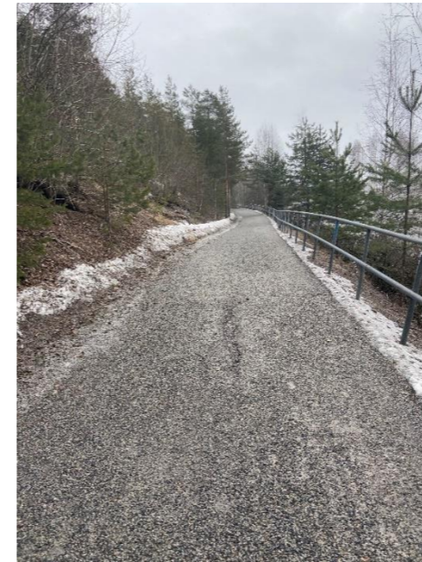
Kuva 47. Lahti–Uusikylä-reitillä oli Lahden keskustan läheisyydessä käytetty todella paljon hiekoitushiekkaa, ja näissä kohdissa lumi ei sulanut tienpintaan osuessaan, vaan alkoi kertymään siihen sohjoksi.
