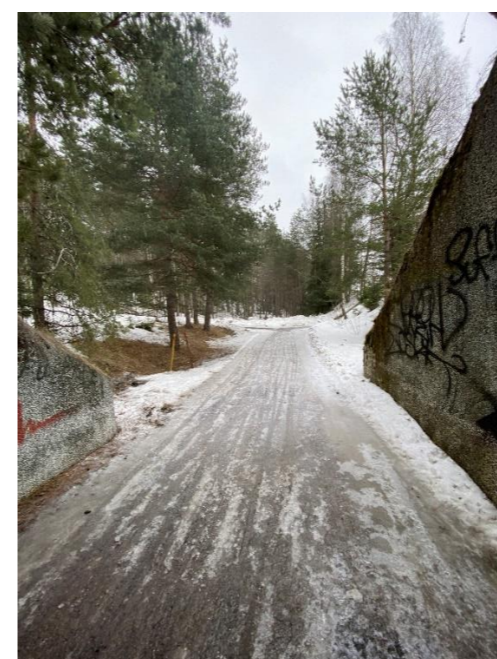
Kuva 51. jäätynyt alikulku, koska kuivatus ei ollut toiminut
