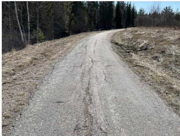
Kuva 24. Useita päällystevaurioita samassa kohdassa Orimattilan pääpyöräväylällä
