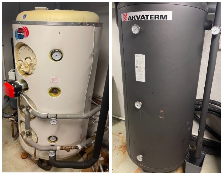
Figur 10 (a) Akvaterms varmvattensbehållare och (b) kallvattensbehållare
