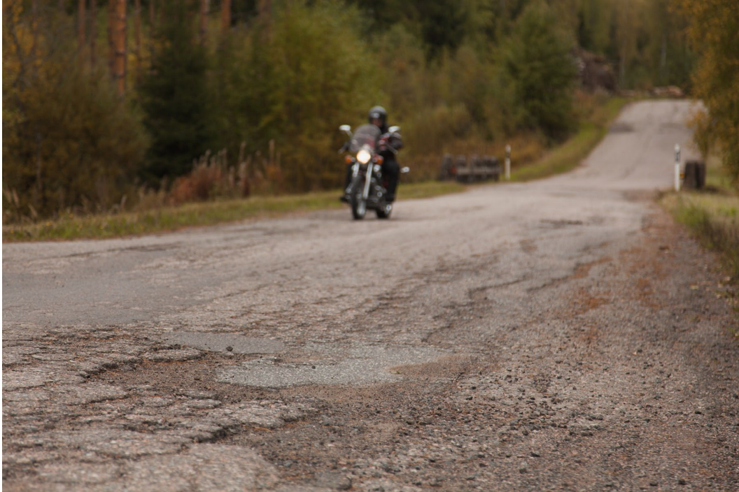
Kuva 6. Päällysteen heikko kunto on turvallisuusriski moottoripyöräilijöille (Väylävirasto).
