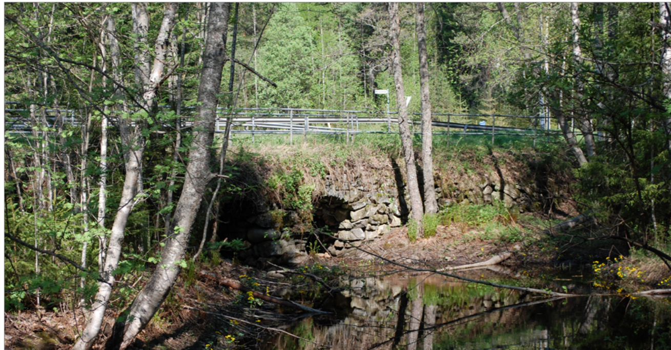
Kuva 59. Myllyjoen vanha silta näkyy parhaiten tien itäpuolelta. Puuston poisto ja kasvillisuuden raivaus sillan ympäristöstä olisi tarpeen säilymisen kannalta.
