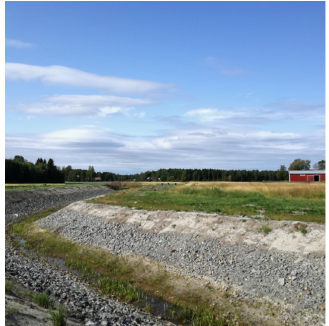
Effektiva erosionsskydd längs utfallsdiken är att göra slänterna flackare och stensätta dem.
