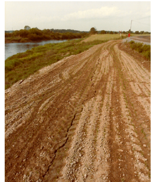
En spricka i marken bredvid fåran kan vara ett tecken på glidyta för skred.
