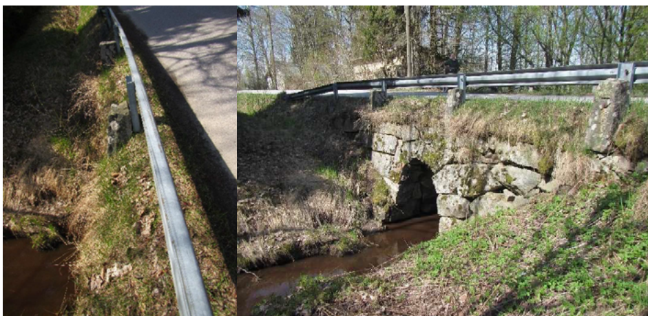
Kuvat: Peliojan vanha kivisilta, reunakaide ja puhdistettavat reunapalteet.
