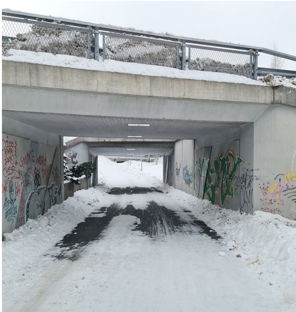
Kuva 20. Valokuva pohjoiselta väylältä Kurkelantien risteyssillan kohdalta 16.2.2021 (EVH-Elektroteknikka Oy, 2021).
