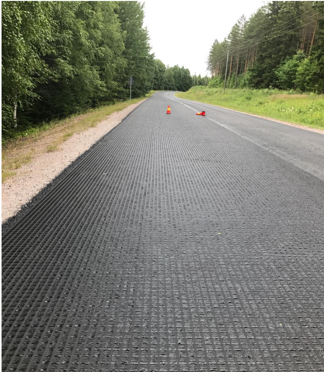
Kuva 17. Bitutex Stargrid 100/100 -verkko on liimattu 8-10 tuntia ennen päällystämistä ja verkko on hyvin kiinni alustassaan.
