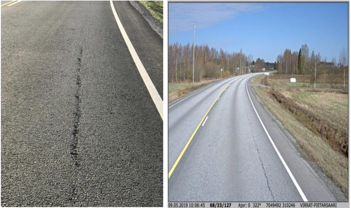
Kuva 17. Lähikuva limityksen kohdalle syntyneestä halkeamasta noin kuukausi päällysteen valmistumisen jälkeen (20.10.2016) ja sama kohta vuonna 2019 kuvattuna (tiekuva 9.5.2019).
