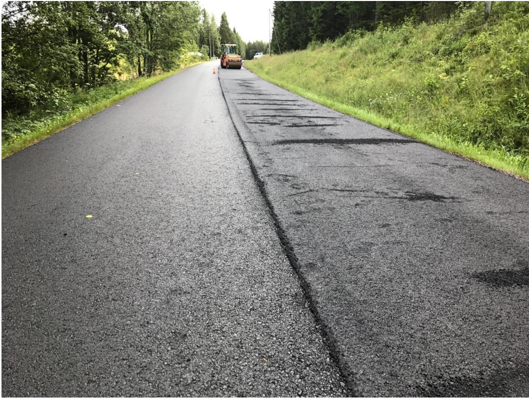
Kuva 29. Kuvan oikealla kaistalla on asennettu suojamassa (AB 16) lasikuituverkon päälle. Verkon poimuttuminen näkyy suojamassan pinnassa.
