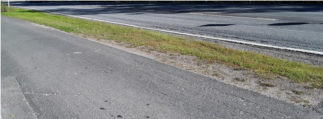
Kuva 10. Pienimuotoinen korjaustarve nurmikaistaleella.
