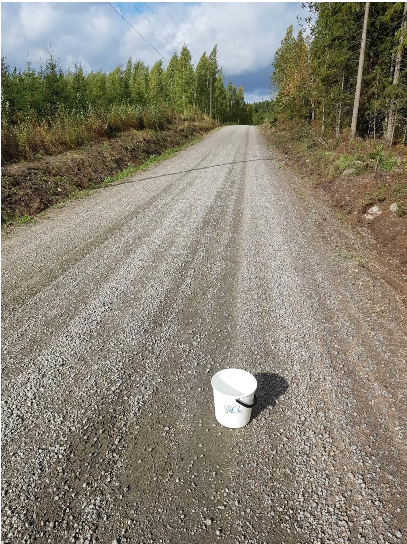
Kuva 21. Soratien pinta alueurakan SRC kohteessa 2.
