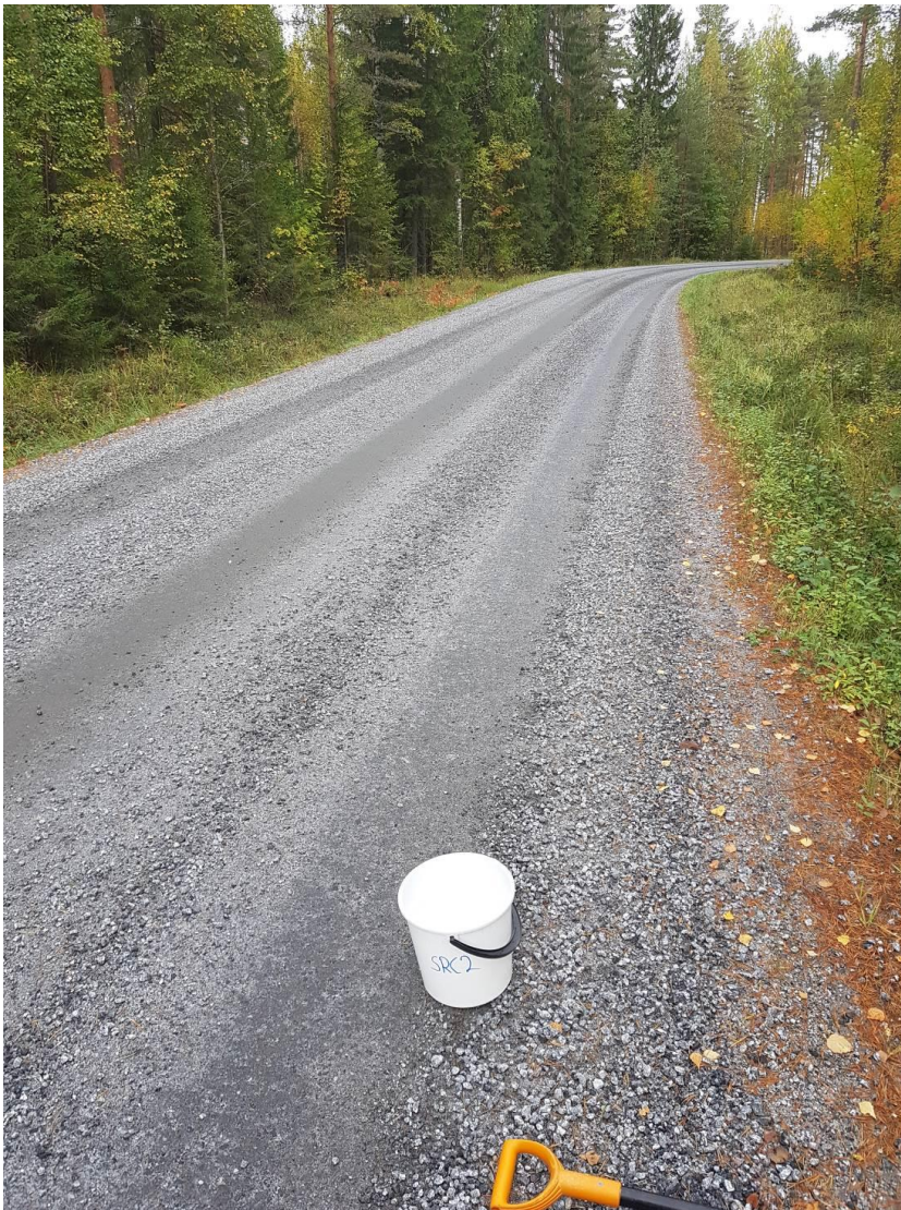
Kuva 18. Soratien pinta alueurakan SRC kohteessa 1.
