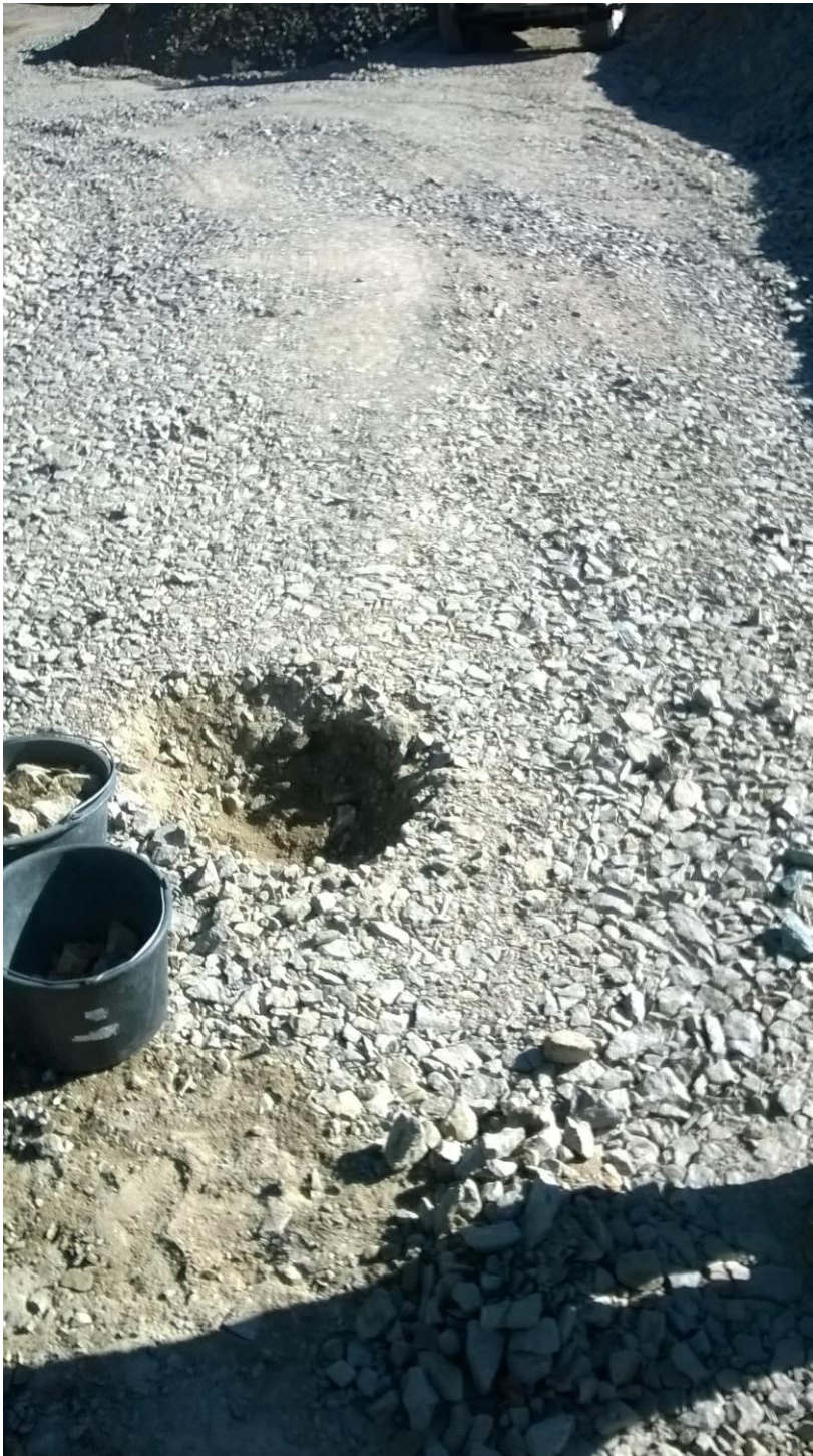
Kuva 4. Radan välikerrokseen kaivettu koekuoppa. Kuopan halkaisija on noin 800 mm ja syvyys noin 250 mm.
