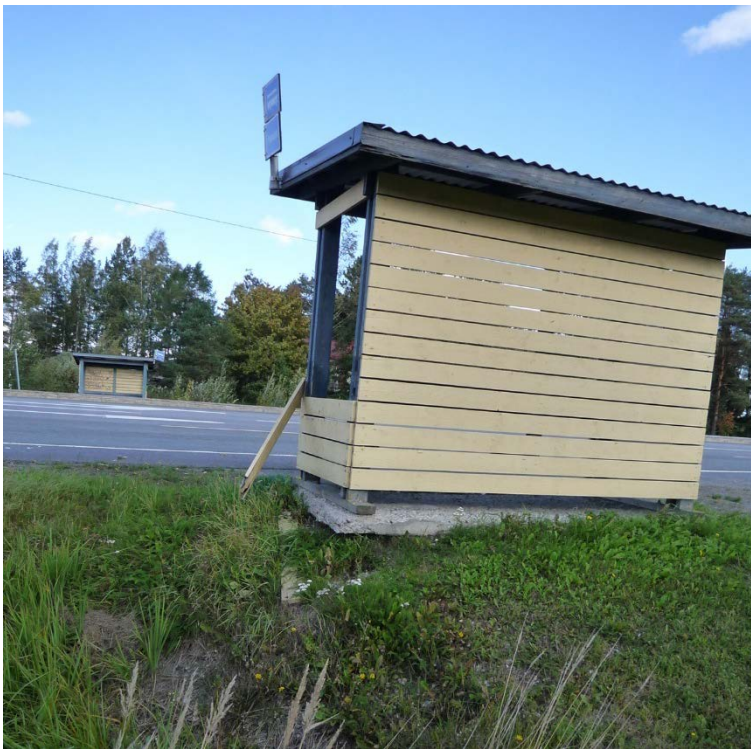
Kuva 27. Häijään tienhaaran pysäkit valtatiellä 11 Sastamalassa tarvitsevat parantamistoimenpiteitä myös perustusten osalta
