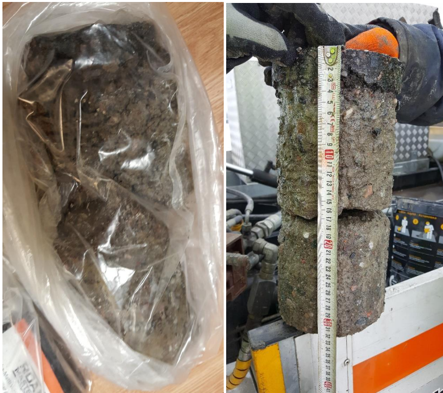
Kuva 15. Esimerkki osittain murentuneesta näytteestä, tie 11146.
